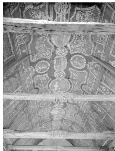
Voûte, vue d'ensemble du lambris peint de l'ouest vers l'est. Phot. Brachet IVR53_19665600961V
