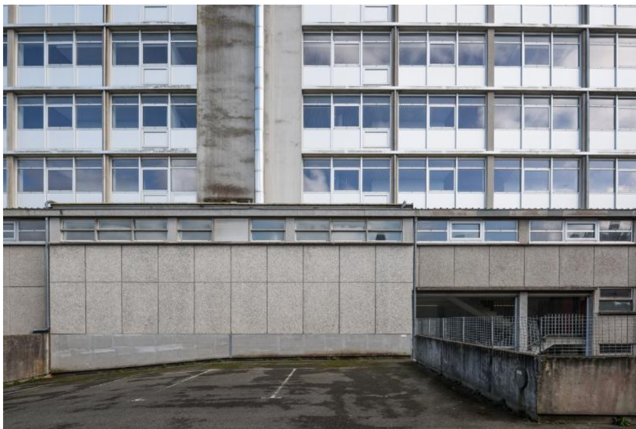
Internat (D), façade arrière. Raymond Lopez architecte, 1958. L'emplacement des anciennes cuisines se manifeste par la différence de couleur des panneaux de parement.
