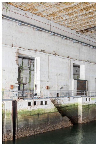
Vue de l'alvéole G (n° 13 et 14) : quai ouest n° 14, détail des équipements Phot. Charlotte Barraud IVR53_20215600653NUCA
