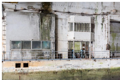
Vue de l'alcôve G (n° 13 et 14) : quai ouest n° 14, détail des équipements, emplacement des pompes des bassins F et G Phot. Charlotte Barraud IVR53_20215600650NUCA
