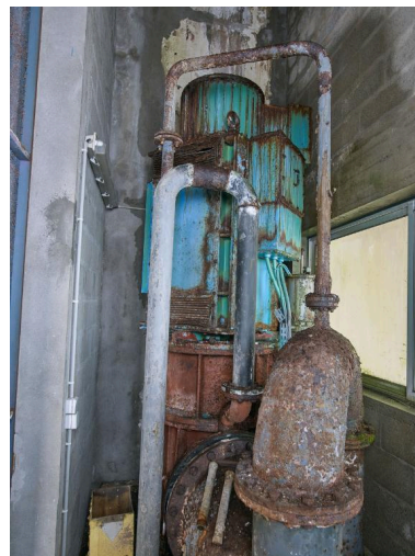
Vue du corps de pompe du bassin G. Deux manivelles sont posées sur le corps de pompe Phot. Bernard Bègne IVR53_20235600031NUCA
