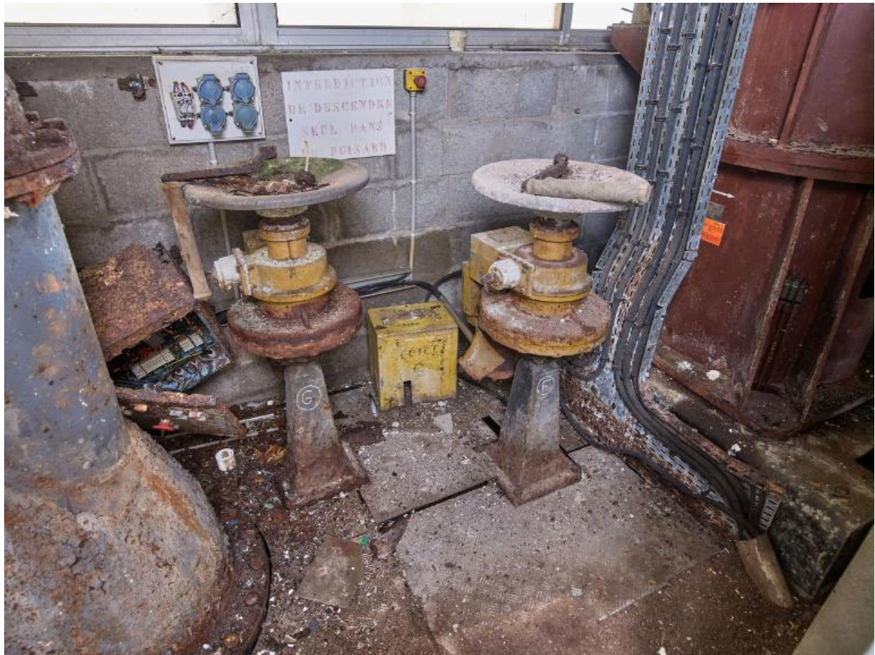
Vue des commandes à volant des pompes des bassins G et F. Deux manivelles sont posées sur les volants
