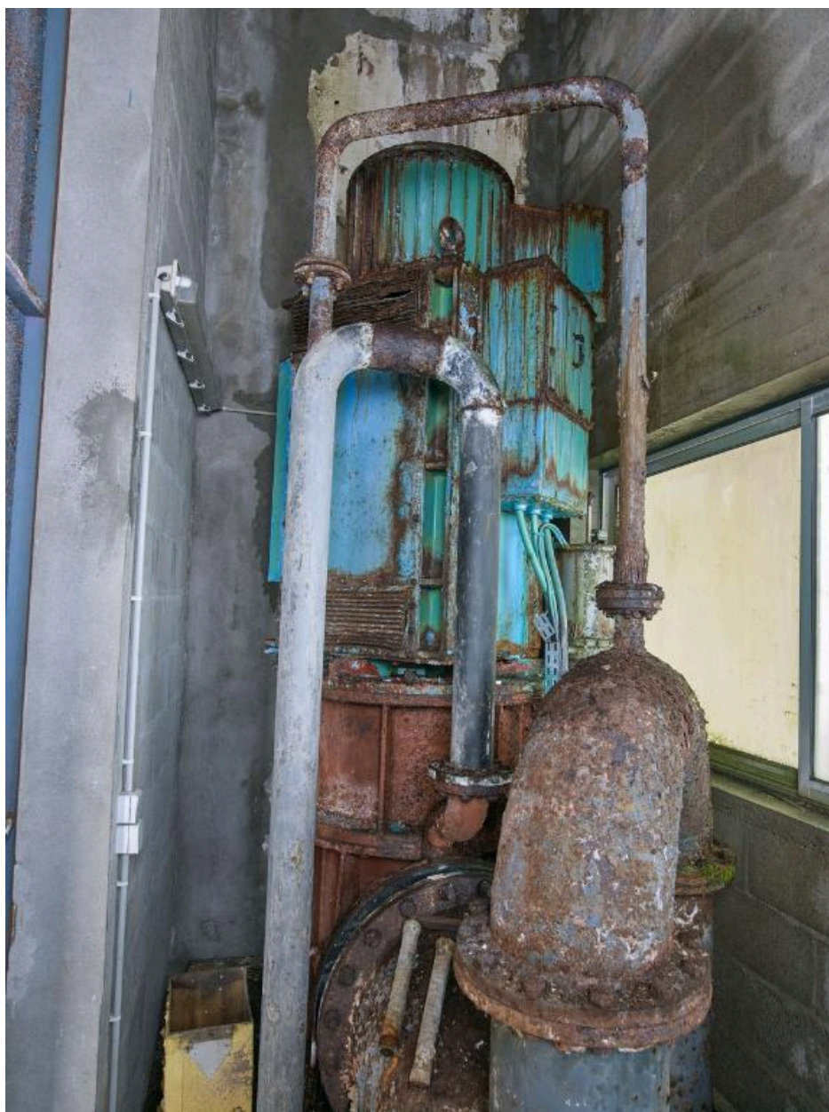
Vue du corps de pompe du bassin G. Deux manivelles sont posées sur le corps de pompe
