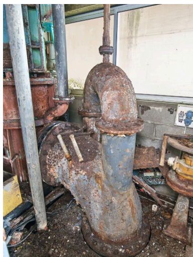
Vue du corps/tuyau de pompe du bassin G. Deux manivelles sont posées sur le tuyau de pompe Phot. Bernard Bègne IVR53_20235600032NUCA
