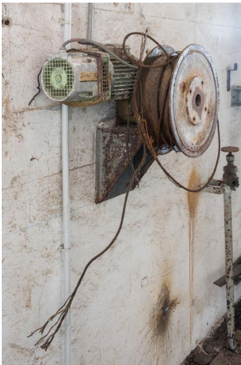
Vue de l'alvéole G (n° 13 et 14) : détail des équipements
