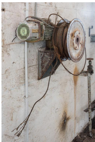
Vue de l'alvéole G (n° 13 et 14) : détail des équipements Phot. Charlotte Barraud IVR53_20215600637NUCA
