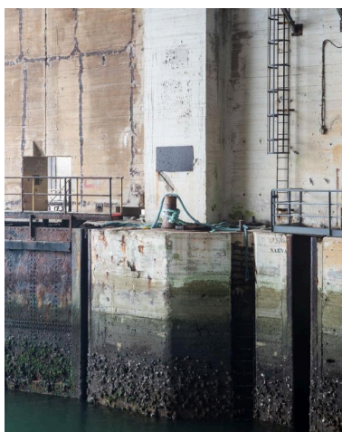
Vue de l'alvéole G (n° 13 et 14) : quai ouest n° 14, détail des équipements Phot. Charlotte Barraud IVR53_20215600654NUCA
