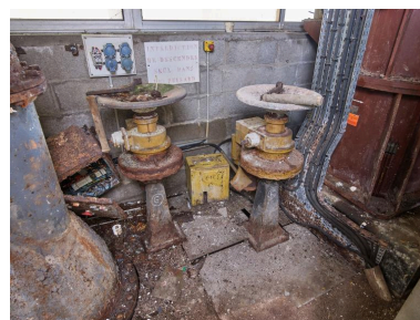
Vue des commandes à volant des pompes des bassins G et F. Deux manivelles sont posées sur les volants Phot. Bernard Bègne IVR53_20235600028NUCA
