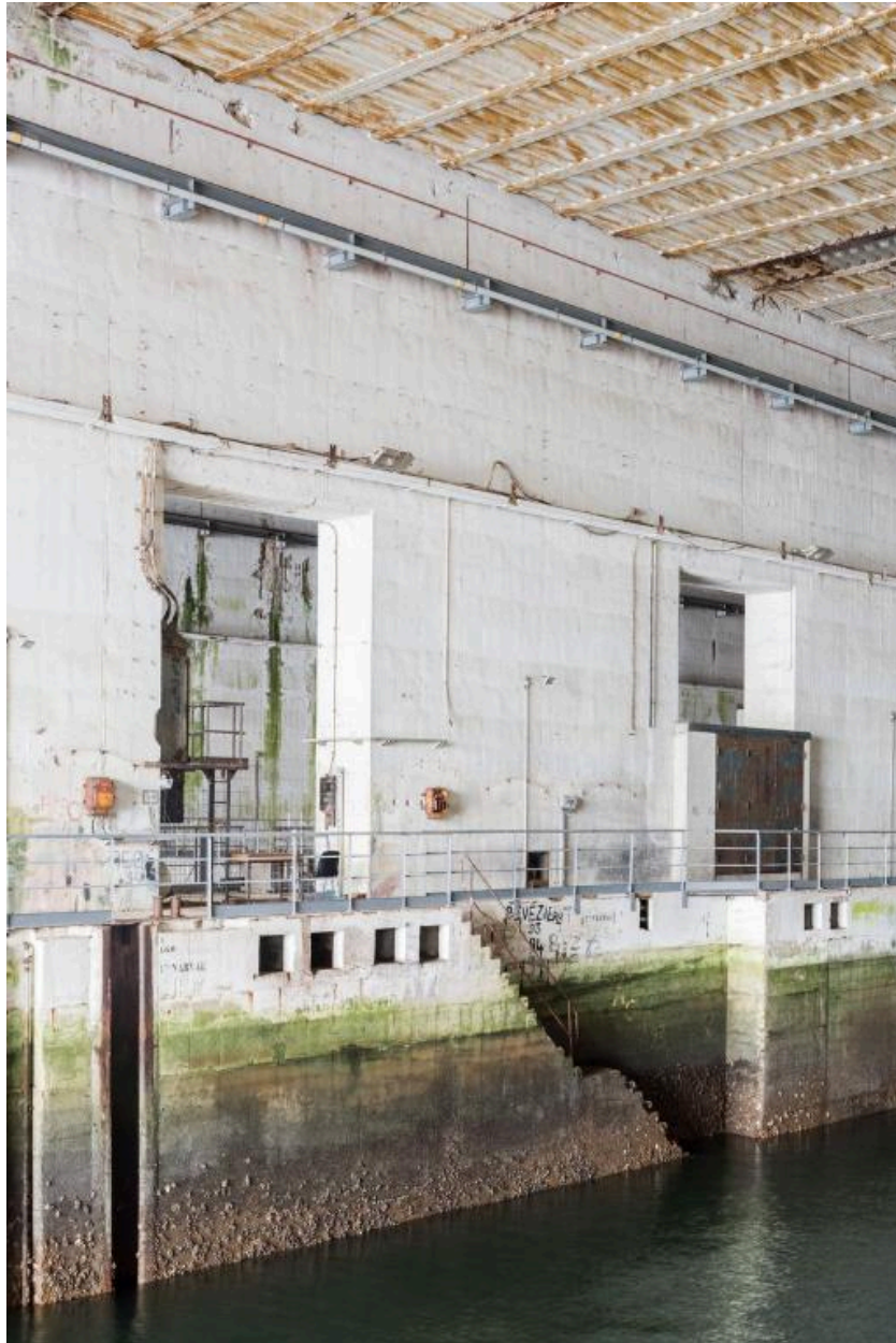
Vue de l'alvéole G (n° 13 et 14) : quai ouest n° 14, détail des équipements
