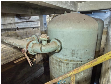
Vue du sous-sol de la salle des groupes électrogènes diesel : extrémité est, deuxième sous-sol, ensemble de deux grands réservoirs Phot. Bernard Bègne IVR53_20235600789NUCA
