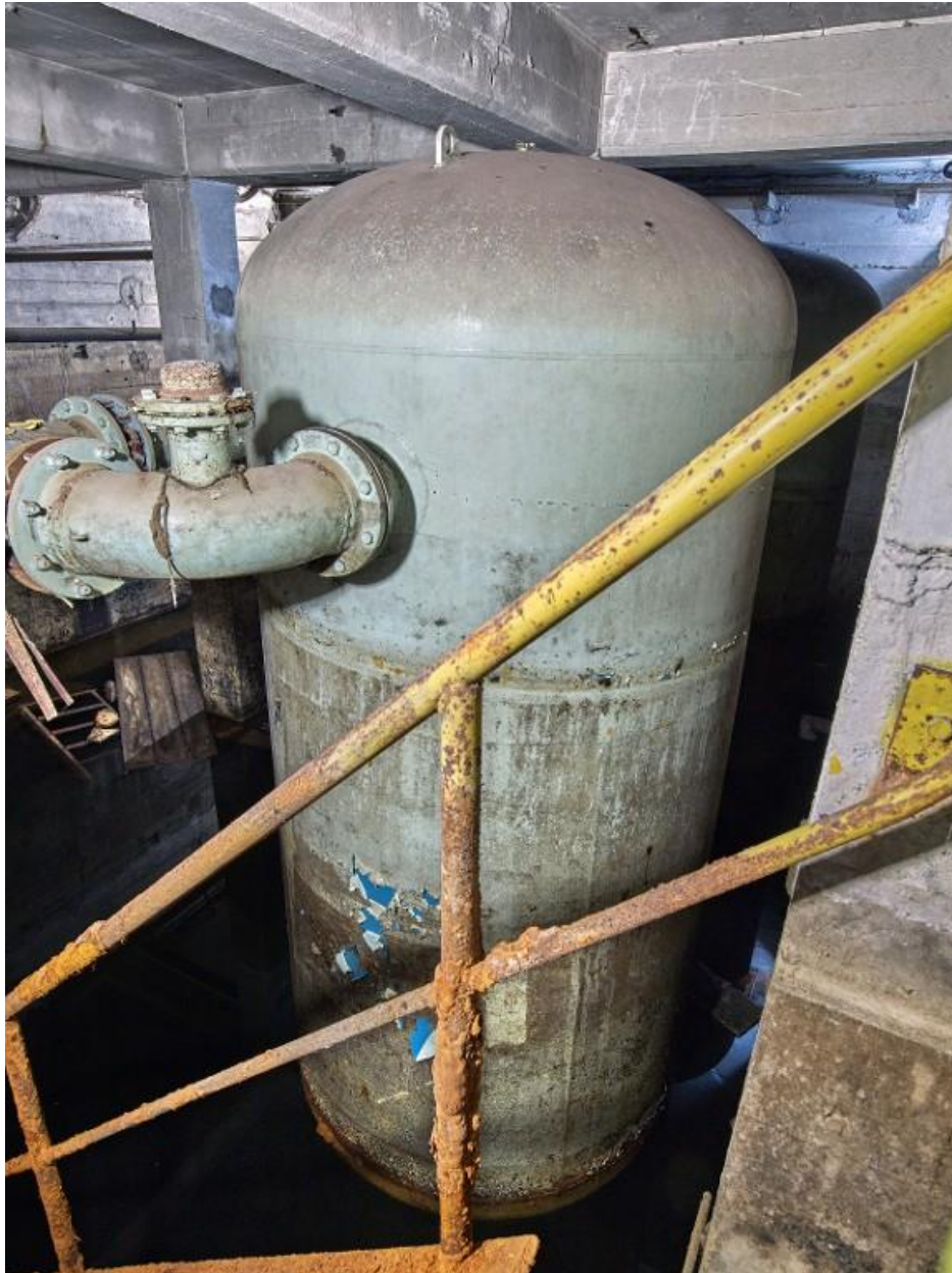
Vue du sous-sol de la salle des groupes électrogènes diesel : extrémité est, deuxième sous-sol, ensemble de deux grands réservoirs
