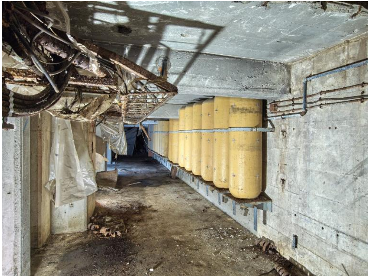
Vue du sous-sol de la salle des groupes électrogènes diesel : ensemble de réservoir d'air comprimé. Ces réservoirs datent de la période française
