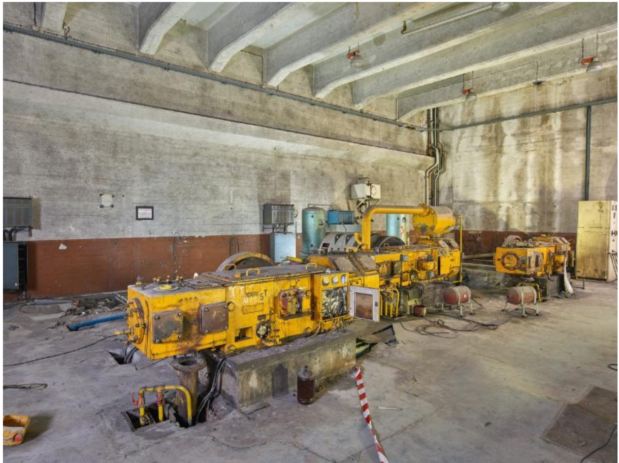
Vue de la salle des groupes électrogènes diesel : ensemble de trois groupes électrogènes alimentant des moteurs asynchrones des Ateliers Bernard Bonnefond Saint-Étienne
