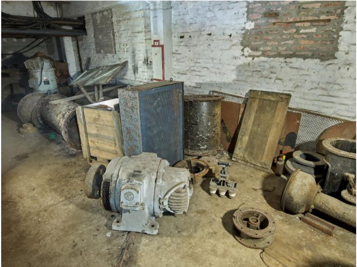
Vue du sous-sol de la centrale électrique : atelier de réparation et magasin de stockage, moteur électrique et autres pièces. On reconnaît le logo ACEC des Ateliers de constructions électriques de Charleroi
