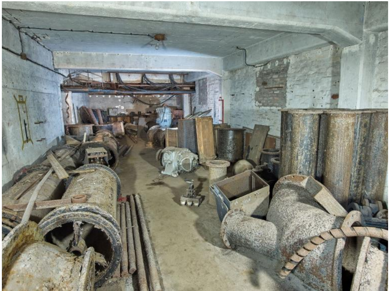
Vue du sous-sol de la centrale électrique : atelier de réparation et magasin de stockage. On reconnaît des pièces détachées de pompe des bassins et des éléments électrique : moteurs, interrupteurs et tableaux...
