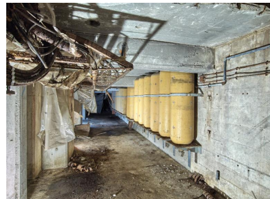
Vue du sous-sol de la salle des groupes électrogènes diesel : ensemble de réservoir d'air comprimé. Ces réservoirs datent de la période française Phot. Bernard Bègne IVR53_20235600792NUCA
