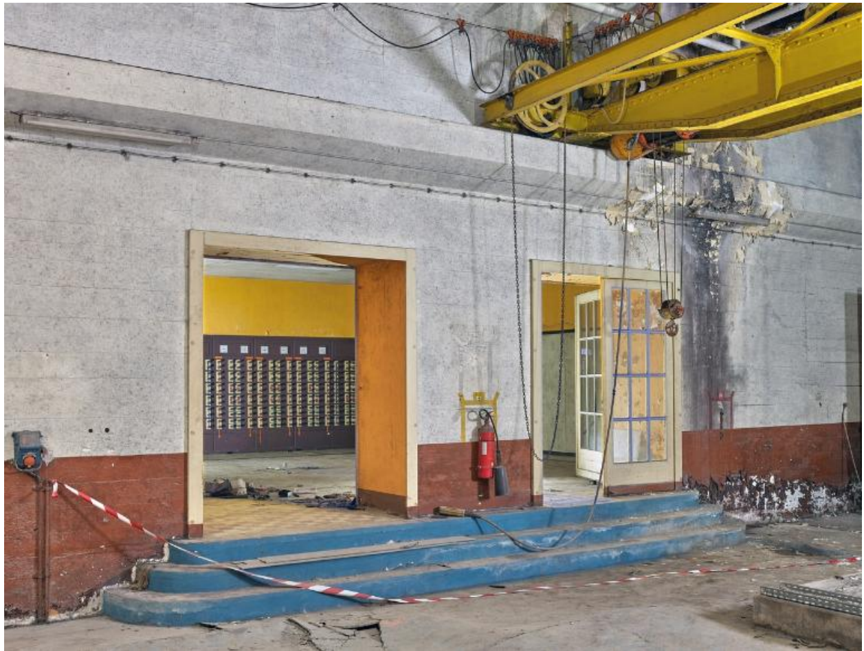
Vue des portes précédées d'un perron donnant accès à la centrale électrique depuis la salle des groupes électrogènes diesel. En haut à droite, le pont roulant d'une capacité de 5 tonnes de la salle des groupes électrogènes
