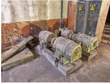
Vue de la salle des groupes électrogènes diesel : ensemble de deux machines à courant continu de la Compagnie générale électrique Nancy Phot. Bernard Bègne IVR53_20235600142NUCA
