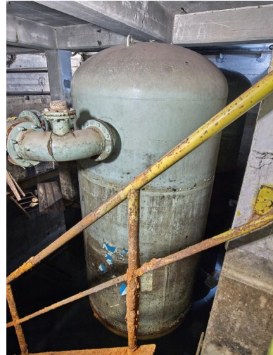
Vue du sous-sol de la salle des groupes électrogènes diesel : extrémité est, deuxième sous-sol, ensemble de deux grands réservoirs Phot. Bernard Bègne IVR53_20235600790NUCA
