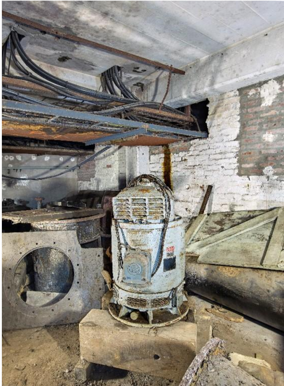
Vue du sous-sol de la centrale électrique : atelier de réparation et magasin de stockage, moteur électrique de pompe avec le logo ACEC des Ateliers de constructions électriques de Charleroi. Suspendu au pafond, chemin de câble électrique
