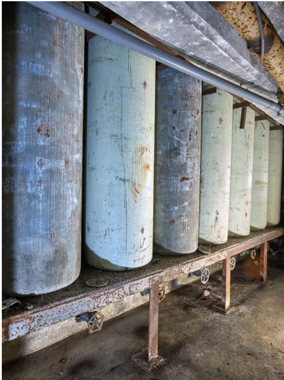
Vue du sous-sol de la salle des groupes électrogènes diesel : extrémité est, ensemble de réservoir d'air comprimé. Ces réservoirs datent de la période allemande
