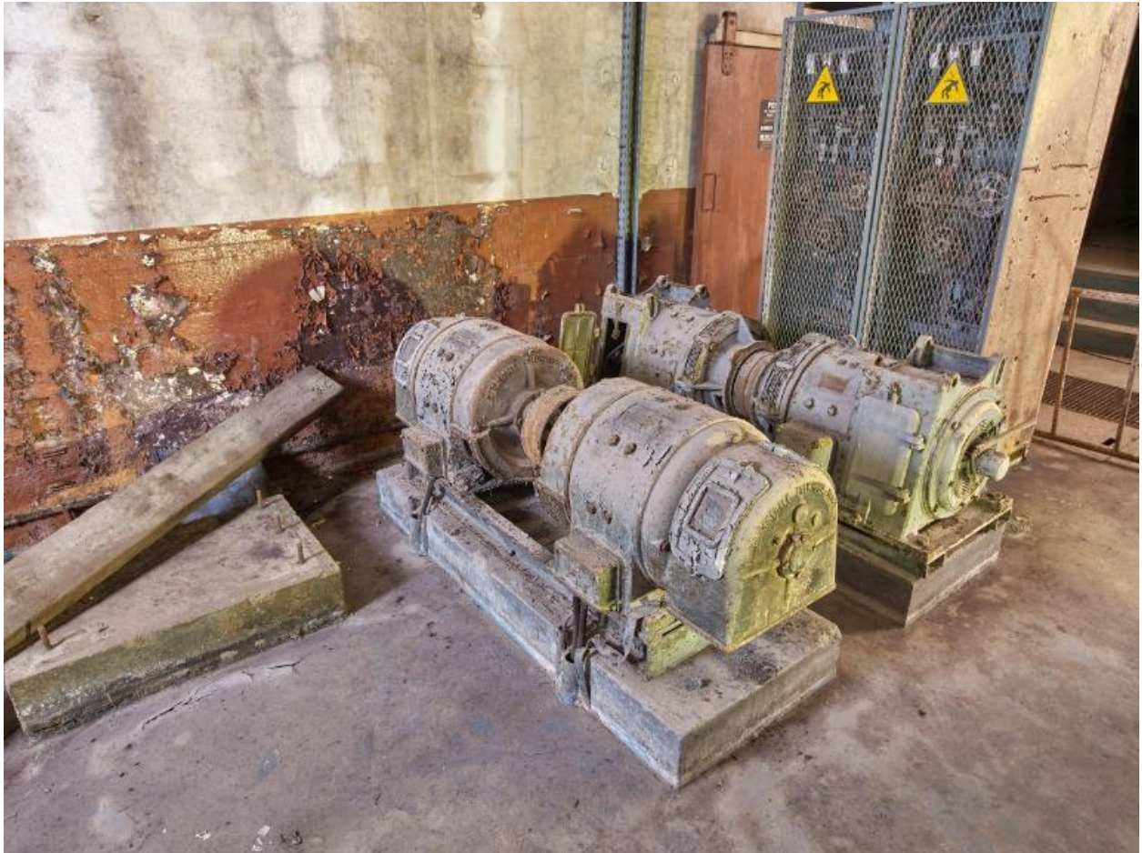
Vue de la salle des groupes électrogènes diesel : ensemble de deux machines à courant continu de la Compagnie générale électrique Nancy
