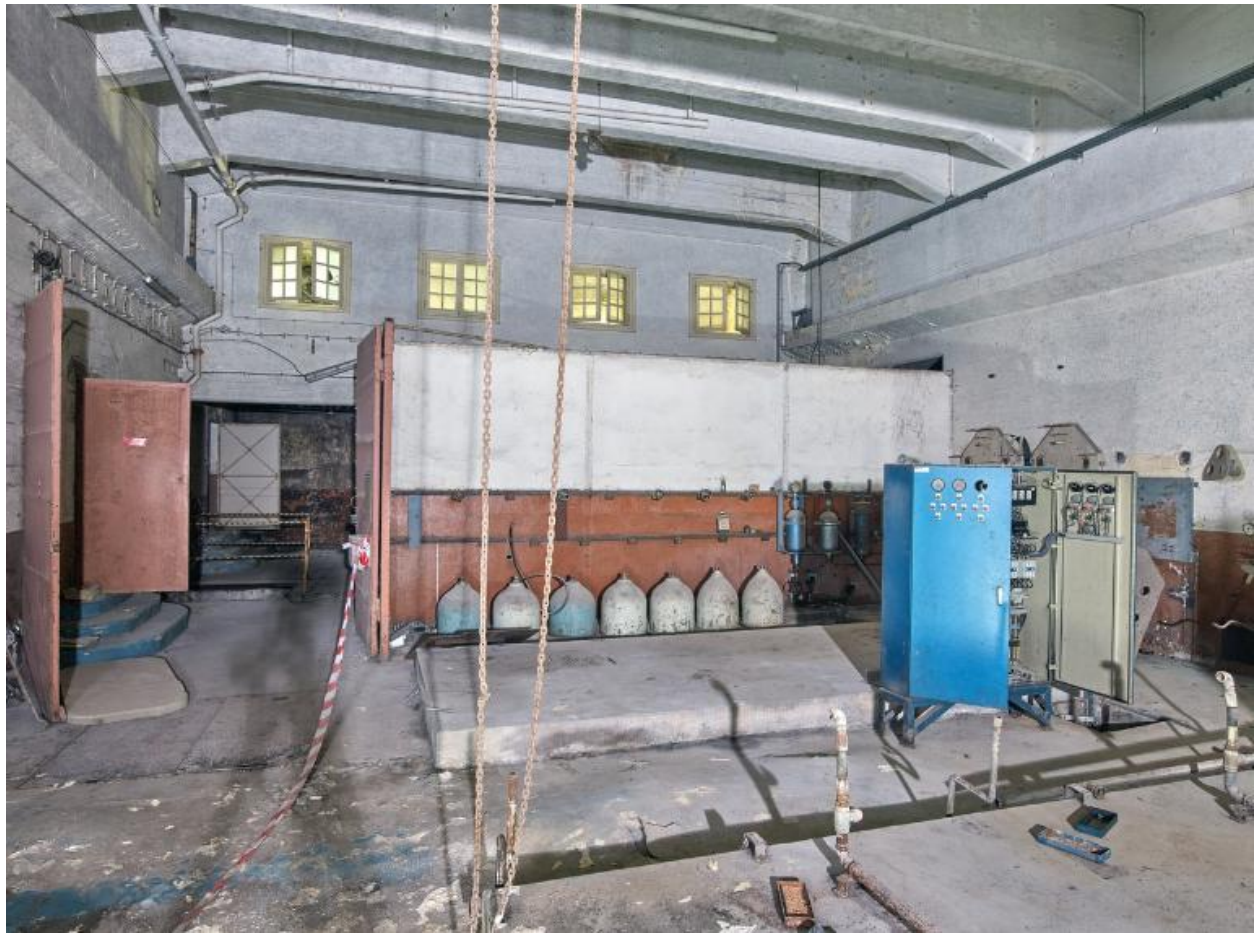
Vue de la salle des groupes électrogènes diesel : extrémité est (production d'air comprimé). Les quatre fenêtres correspondent à deux bureaux situés au premier étage. Derrière la cloison, quai de chargement
