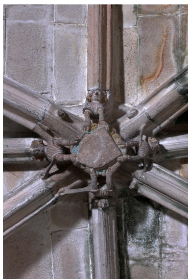
Déambulatoire du chœur, clef de voûte, écu muet et tenants Phot. Norbert Lambart IVR53_20072200277NUCA
