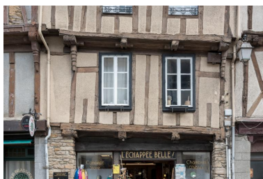
La modification des baies laisse des marques dans l'organisation du pan de bois (potelets non reliés, traverses et poteaux disparus). Phot. Charlotte Barraud IVR53_20222900534NUCA
