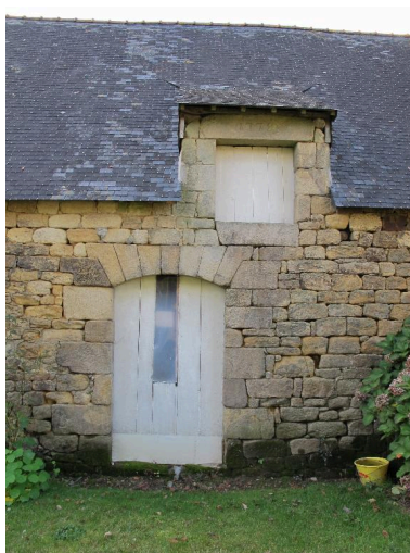
Ferme, détail de la porte de l'étable et de la fenêtre de grenier datée 1778, état en 2015 Phot. Catherine Toscer IVR53_20155606971NUCA
