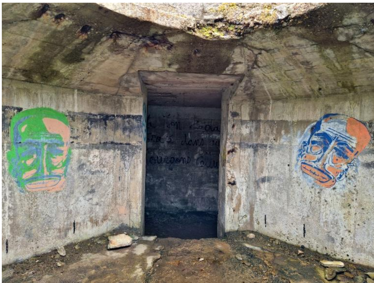
Vue intérieure : accès à l'escalier desservant le poste d'observation et de tir. Les murs sont tagués
