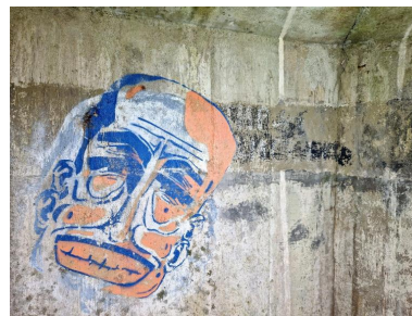
Vue intérieure : poste d'observation et de tir. Les murs sont tagués Phot. Guillaume Lécueillier IVR53_20242911184NUCA
