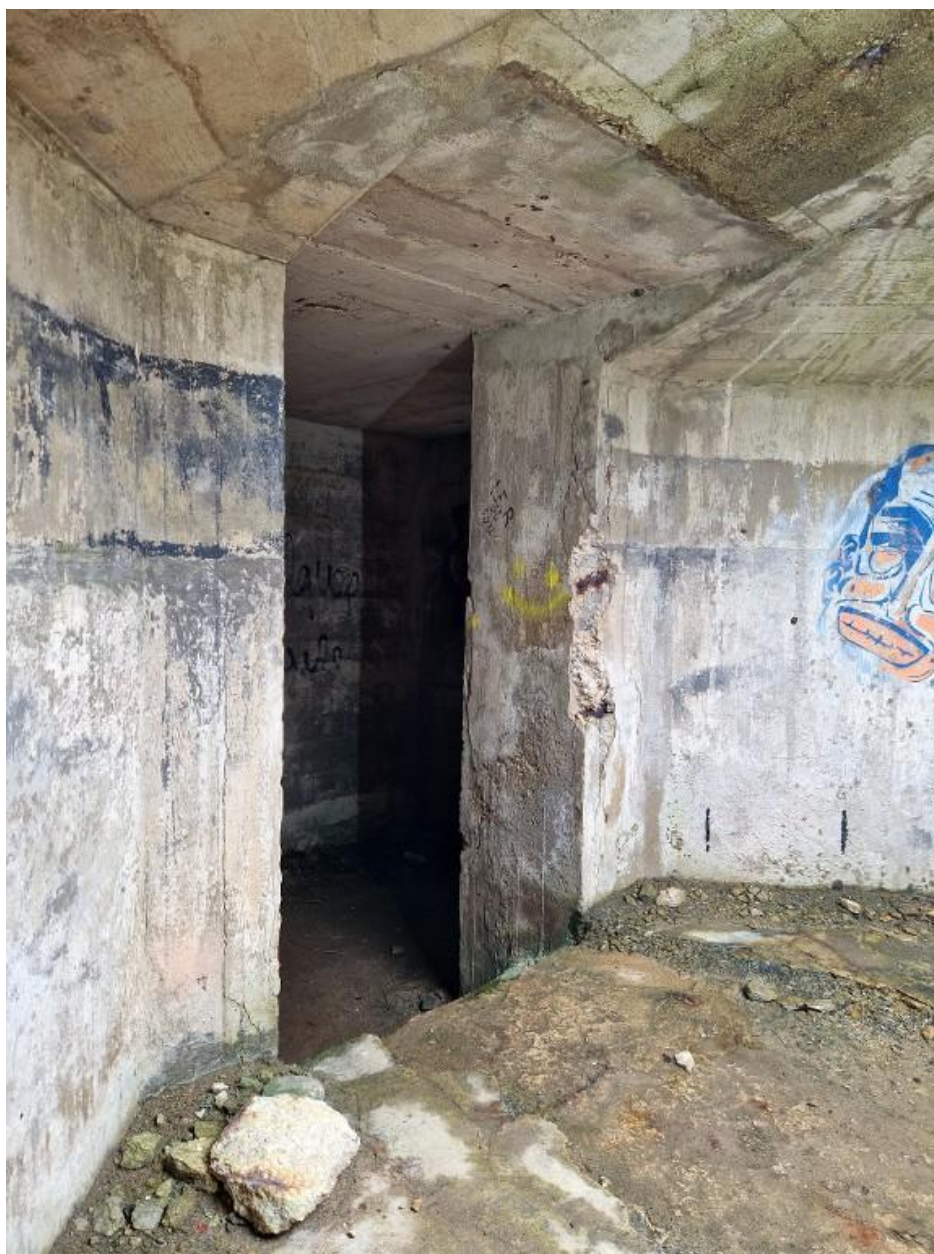
Vue intérieure : accès à l'escalier desservant le poste d'observation et de tir. Les murs sont tagués
