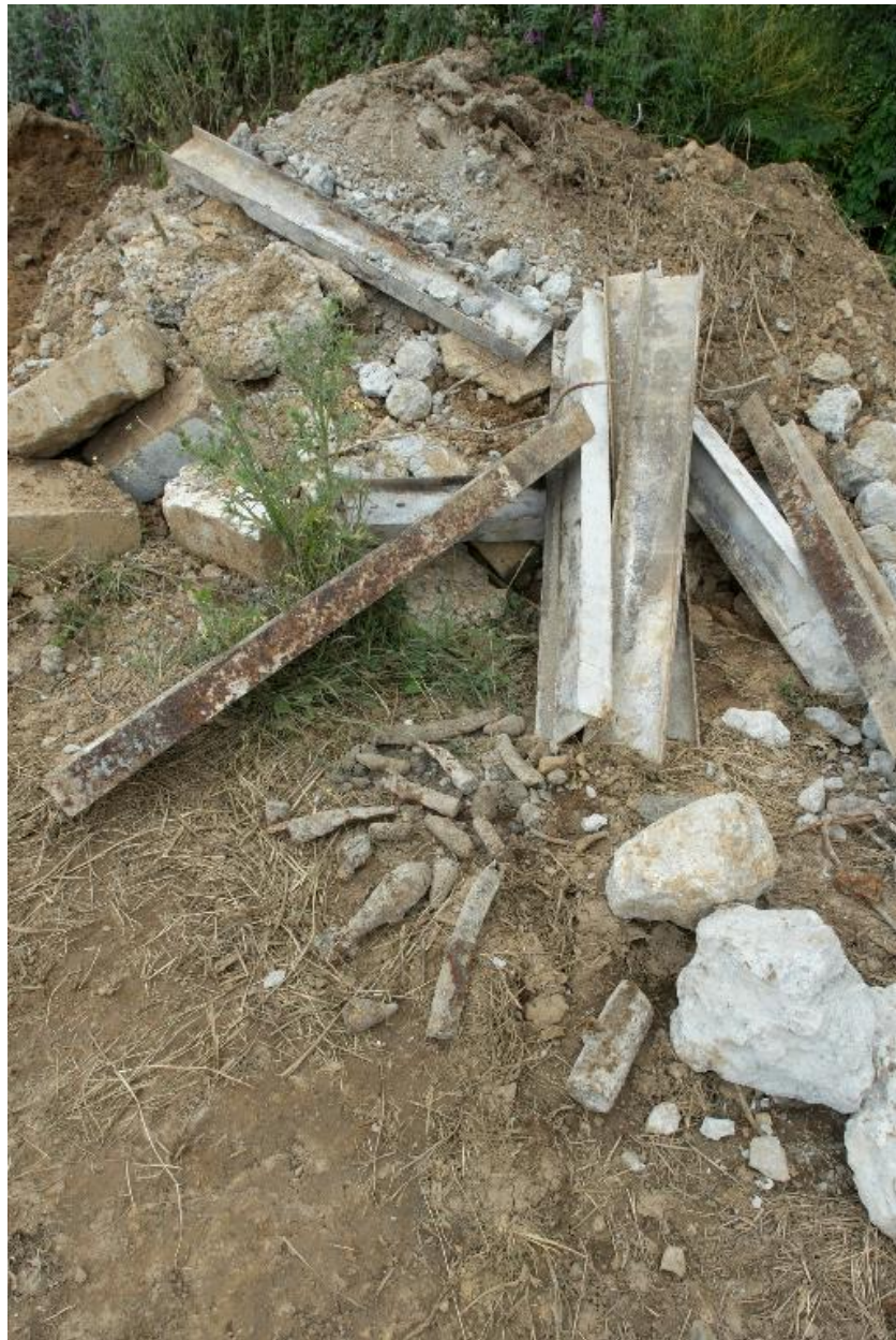
Vestiges métalliques et matériels pyrotechniques (projectiles de différents types...) découverts lors de la déconstruction des bunkers
