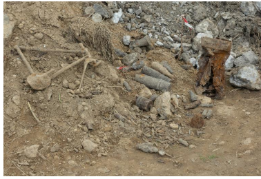
Vestiges métalliques et matériels pyrotechniques (projectiles de différents types...) découverts lors de la déconstruction des bunkers
