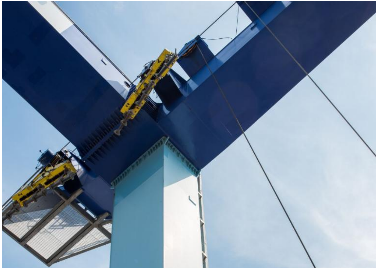
Vue de détail de l'élévateur à bateaux
