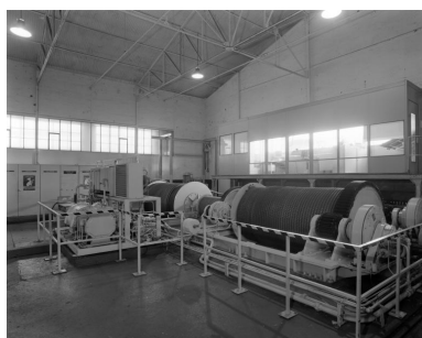
Vue du treuil de hissage principal du slipway en 2000 Phot. Bernard Bègne IVR53_20005600581X
