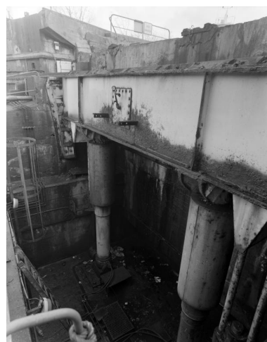
Vue de détail du pont basculant et tournant dans sa fosse bétonnée en 2000 : vérins, levage sud Phot. Bernard Bègne IVR53_20005600574X
