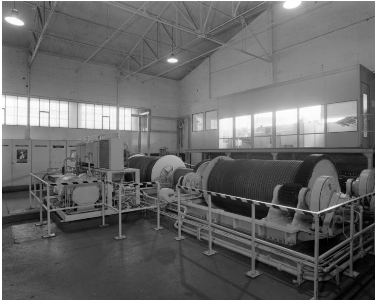
Vue du treuil de hissage principal du slipway en 2000
