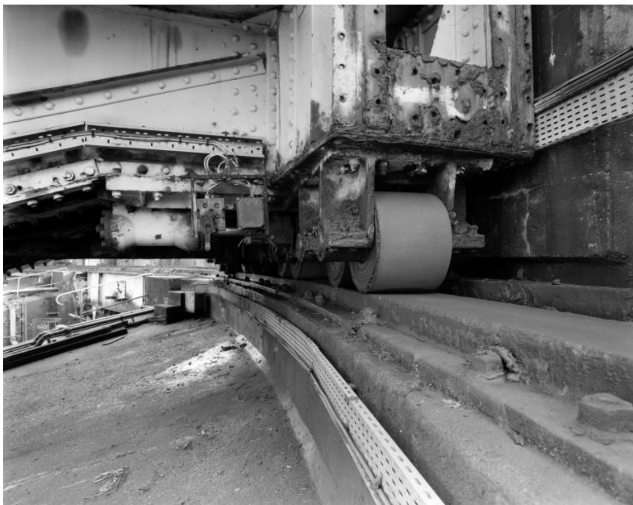
Vue de détail de la fosse bétonnée du pont basculant et tournant en 2000 : chemin de roulement
