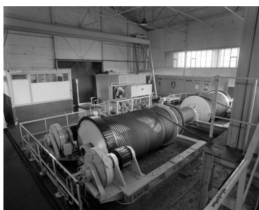
Vue du treuil de hissage principal du slipway en 2000 Phot. Bernard Bègne IVR53_20005600569X
