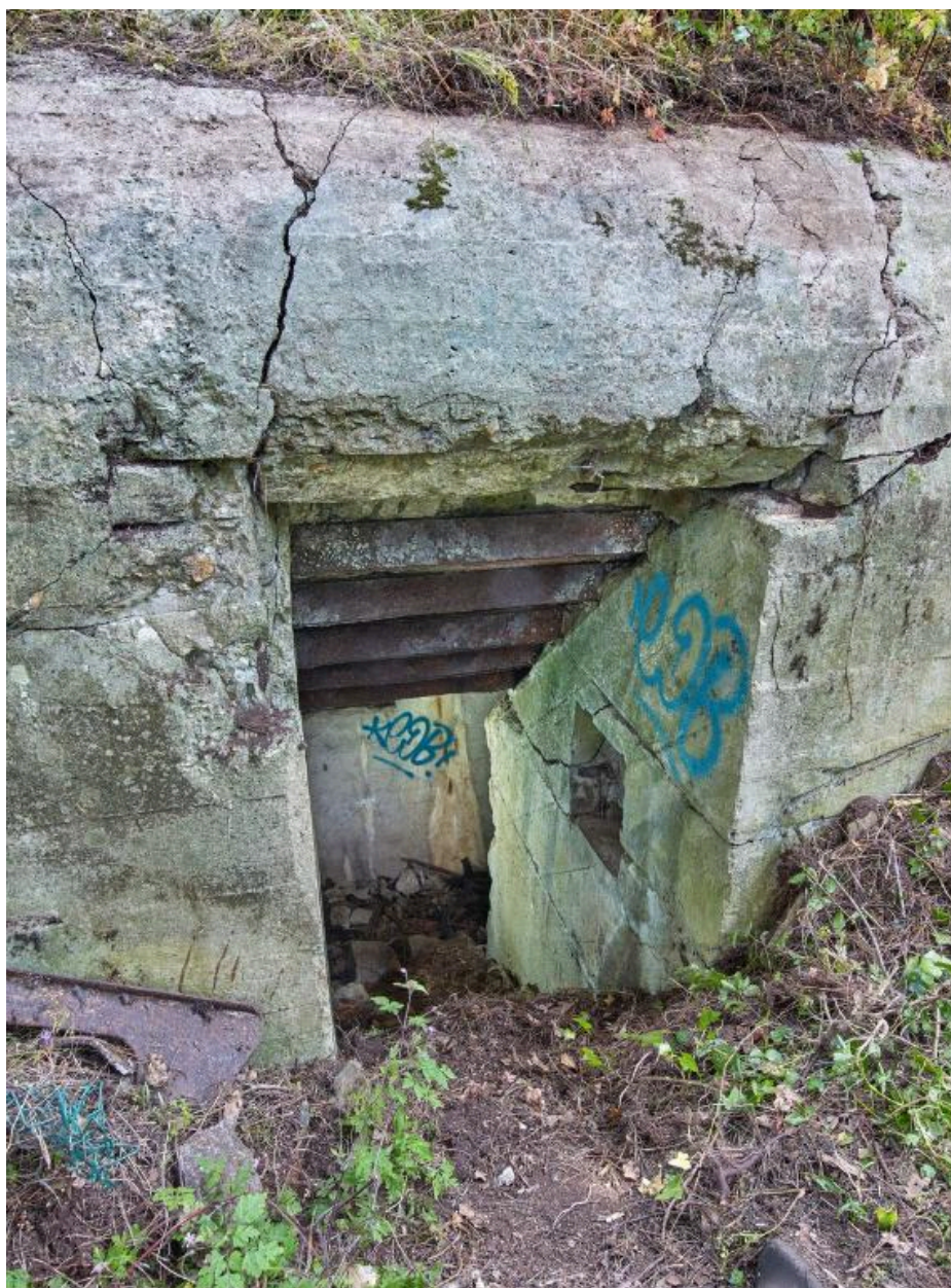
Vue de l'entrée Sud (partiellement murée par des parpaings et remblayée). Dalle de couverture et murs périphériques mesurent 2 m d'épaisseur. Le béton armé a pourtant été fissuré par l'explosion interne
