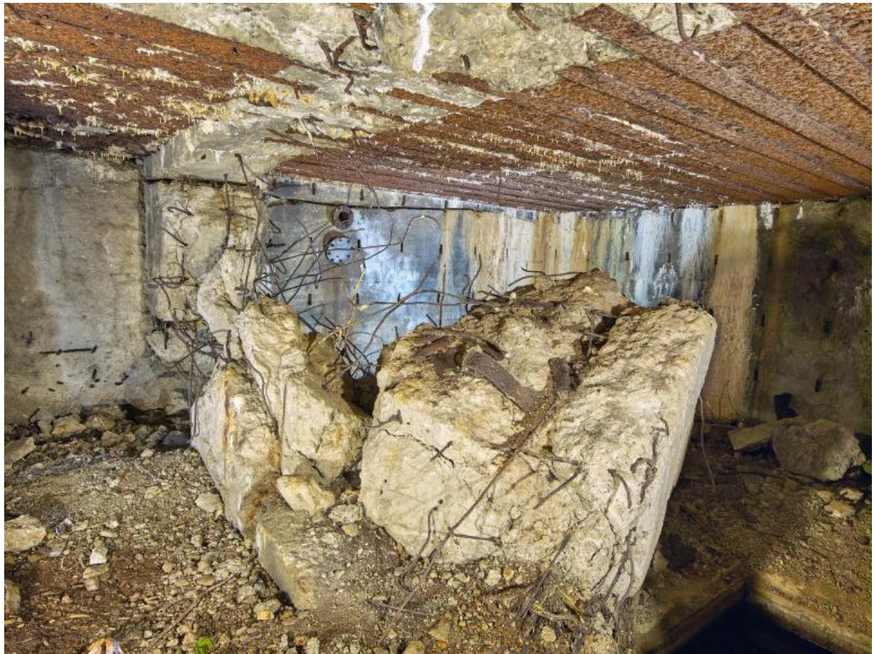
Vue de la pièce de vie - chambrée Nord depuis le sas : résultat de l'explosion, mur en béton projeté et basculé du sas et fers à béton entrelacés
