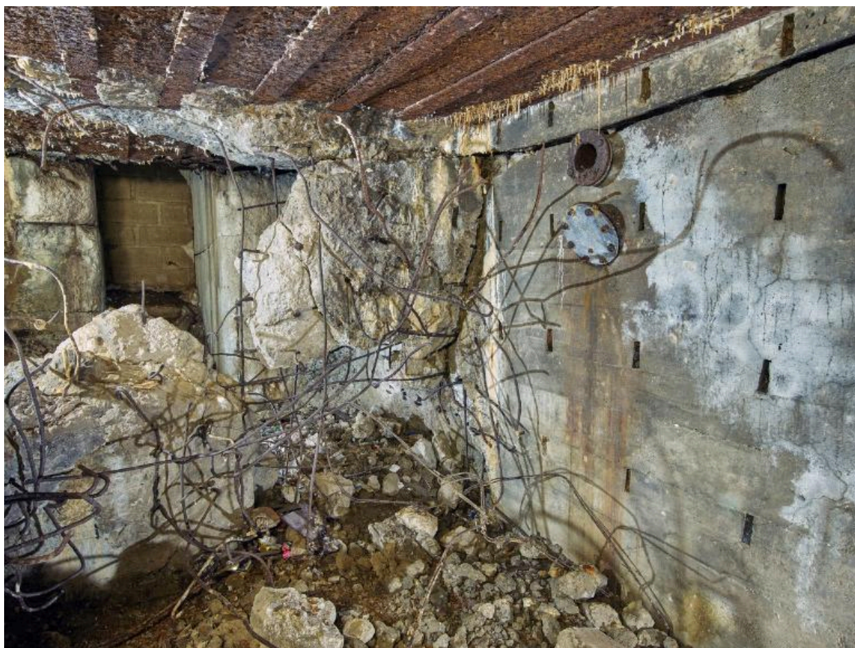
Vue de la pièce de vie - chambrée Nord : résultat de l'explosion sur le mur du sas, fers à béton entrelacés. Dans le mur, conduit de cheminée du poêle et conduit de ramonage (fermé par un couvercle boulonné)
