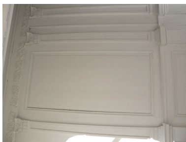
Vue des anciennes boiseries à l'intérieur du bâtiment Phot. Guy Prigent IVR53_20082213466NUCA
