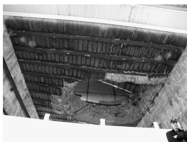
Vue intérieure de la base de sous-marins : cratère de bombe Tallboy (2004) Phot. Guillaume Lécueillier IVR53_20042903981NUCA
