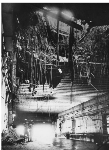
Vue intérieure de la base de sous-marins : cratère de bombe Tallboy dans l'alvéole n° 2 Repro. Guillaume Lécueillier IVR53_20042904392NUCA
