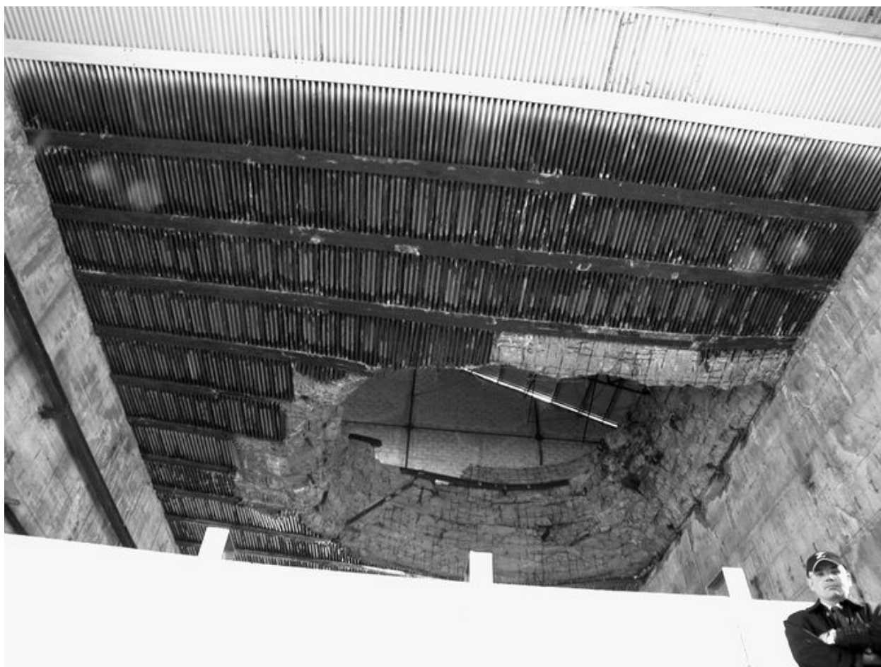
Vue intérieure de la base de sous-marins : cratère de bombe Tallboy (2004)
