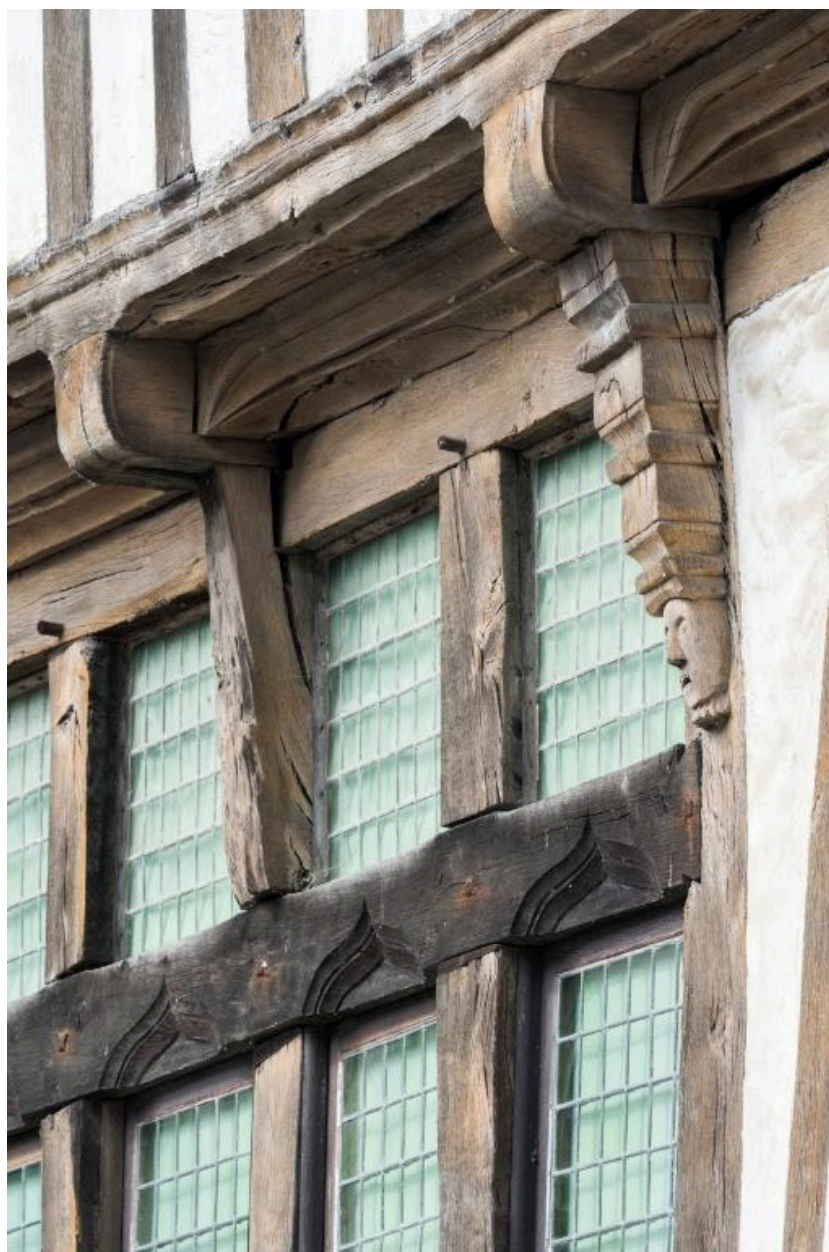
Détail des moulures sur une partie remaniée de la façade en pan de bois.
