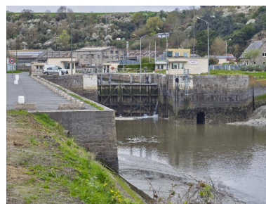
Vue de situation de l'écluse en aval depuis les perrés et quai d'attente Phot. Bernard Bègne IVR53_20262200282NUCA
