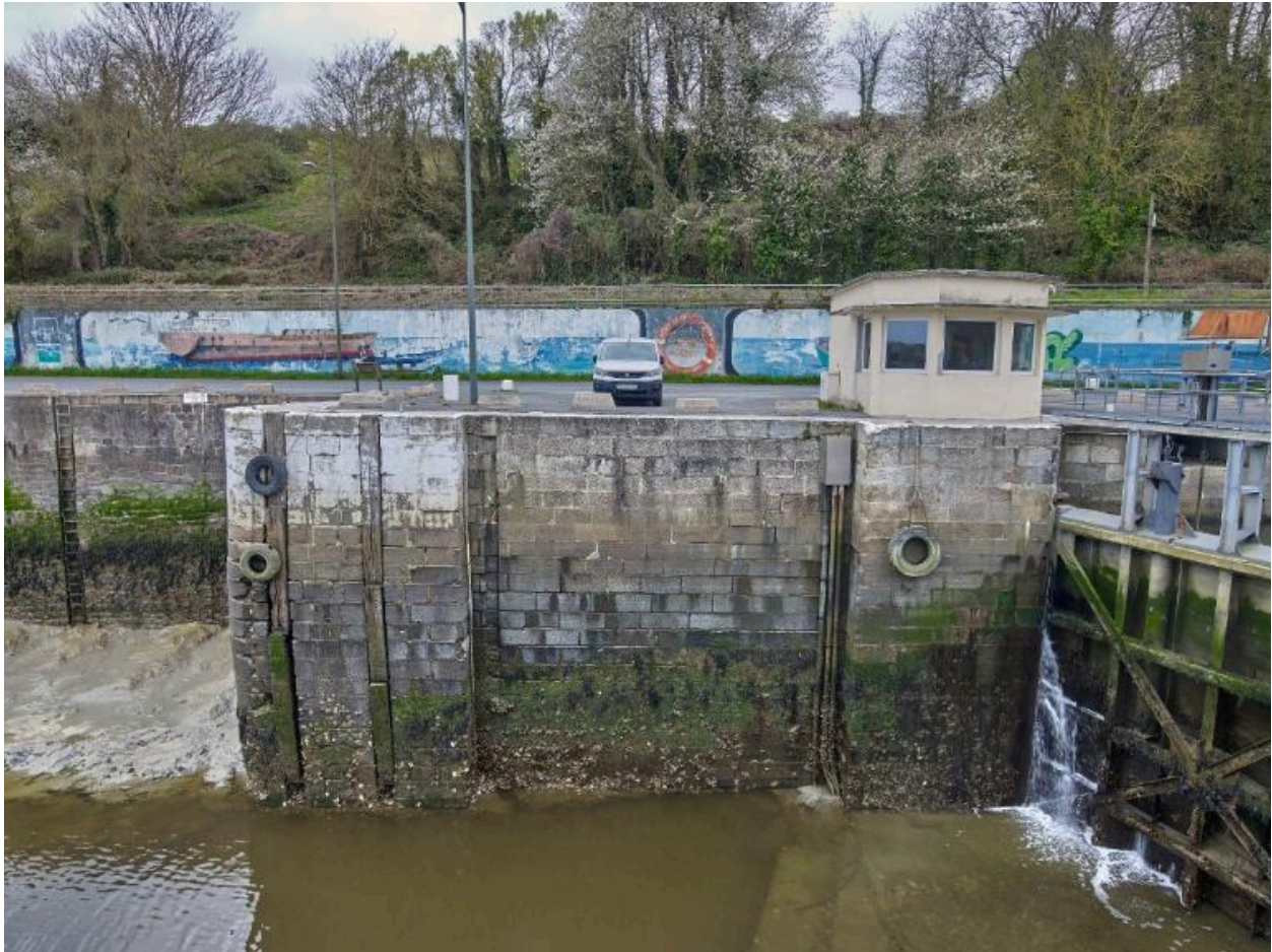
Tête aval de l'écluse : quai d'attente et de quidage, musoir, rainure à batardeau, maçonnerie de pierre de taille, poste de commande, porte busquée et faux-busc
