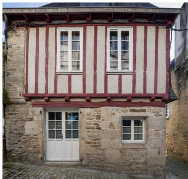
Etage en encorbellement sur solives et contreventement en grille. Phot. Charlotte Barraud IVR53_20252900697NUCA
