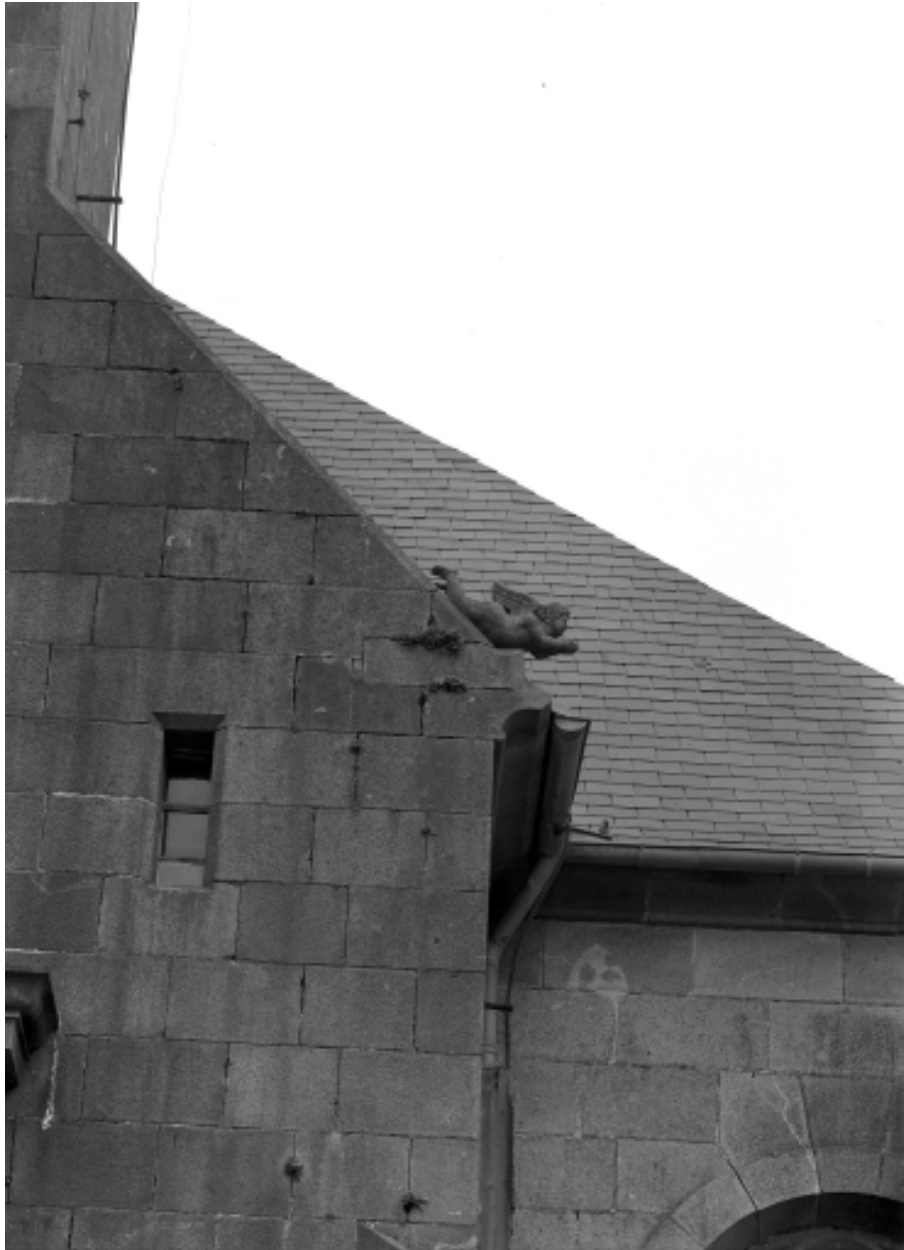
Port-Launay, église paroissiale Saint-Nicolas : façade ouest, détail crossette sculptée, état en 1972
