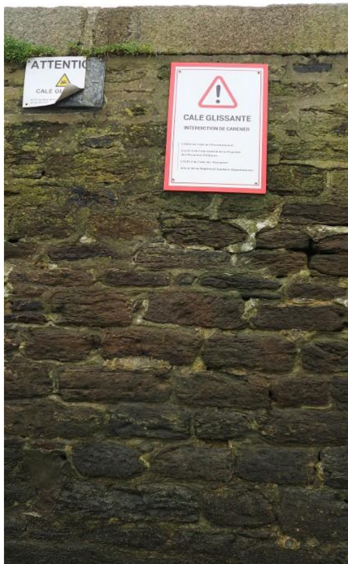
Môle Saint-Christophe : panneaux de sécurité
