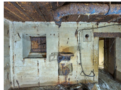
Vue de détail de la salle de garde : de gauche à droite, ouverture de tir blindée de l'entrée nord ; emplacement du système de ventilation avec arceau pour les filtres à charbon et tuyauterie au plafond ; à droite, porte étanche d'accès Phot. Bernard Bègne IVR53_20253501384NUCA
