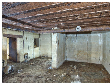
Vue de la salle de garde : elle est partiellement divisée par un mur de refend. A gauche, porte étanche d'accès et bouche de surpression à clapet. Au plafond, tuyauterie du système de ventilation Phot. Bernard Bègne IVR53_20253501383NUCA
