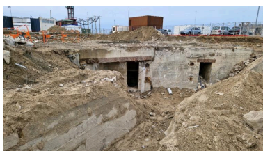
Vue de l'élévation est (couverture photographique du 17 décembre 2025). Au premier plan à gauche, le quai de l'avant-port de Saint-Servan : il est construit en maçonnerie de pierre de taille de granite Phot. Guillaume Lécueillier IVR53_20263510056NUCA
