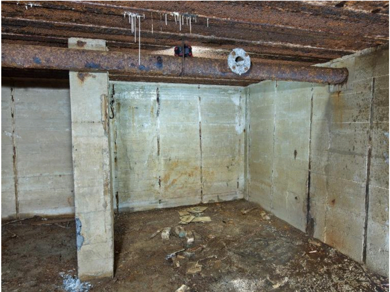
Vue de détail de la salle de garde : elle est partiellement divisée par un mur de refend. Au plafond, tuyauterie du système de ventilation
