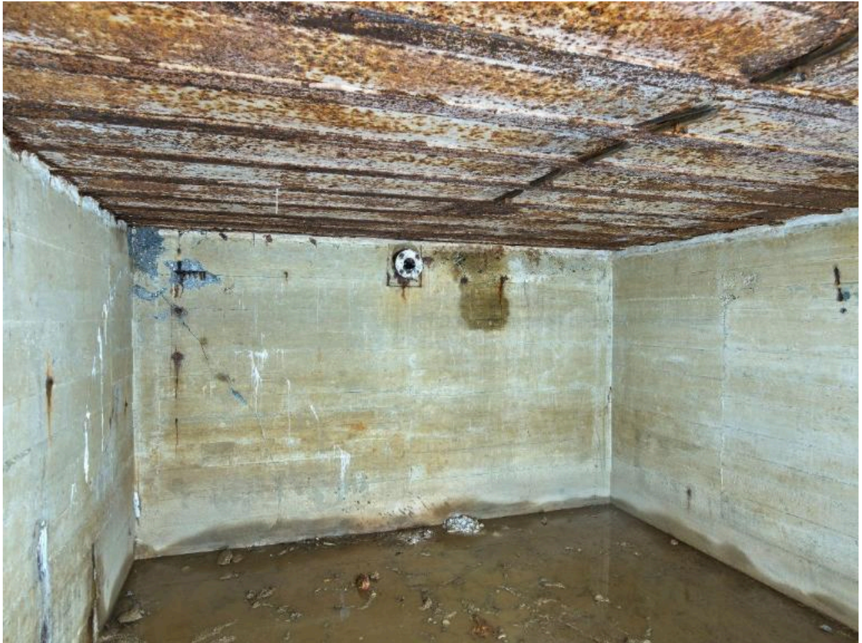
Vue du magasin à munitions situé au sud. Sur le mur du fond : bouche de ventilation
