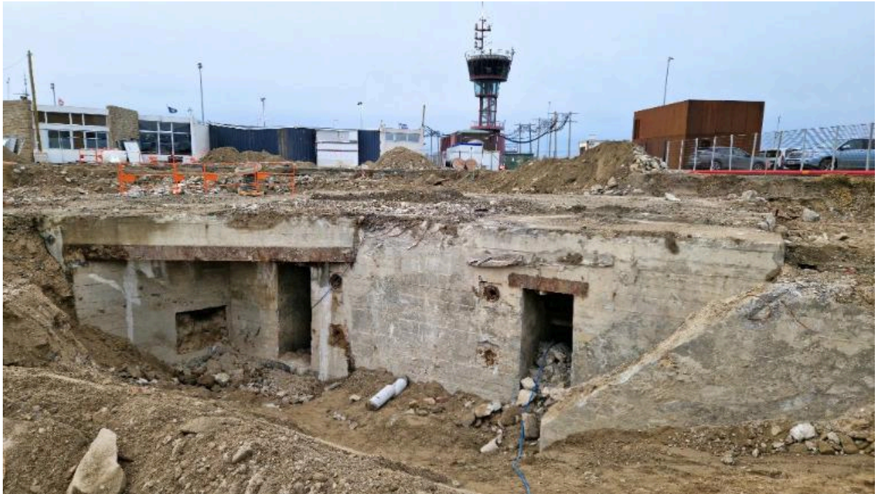
Vue générale de l'élévation est (couverture photographique du 17 décembre 2025). En arrière-plan, la tour de la capitainerie du port de Saint-Malo
