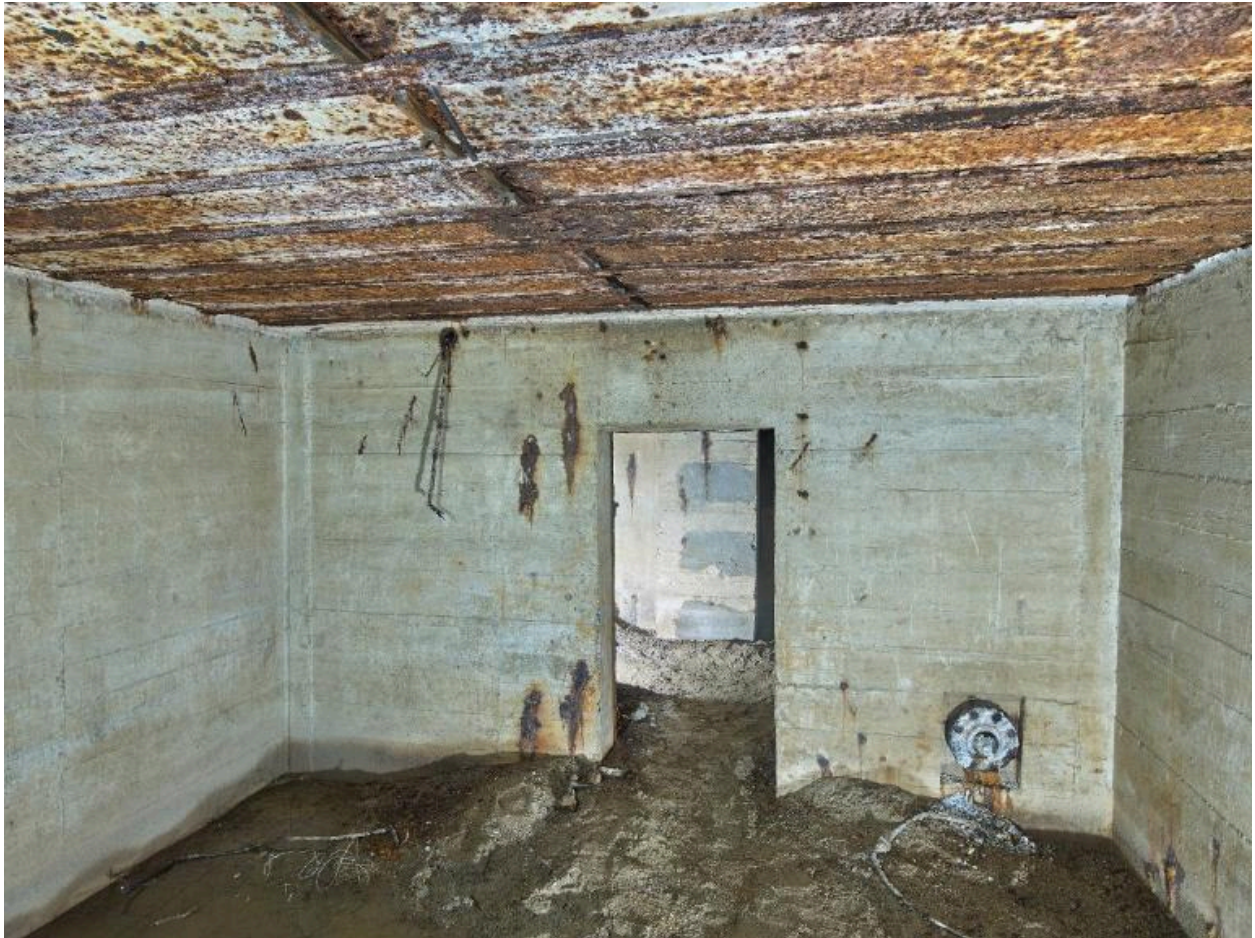
Vue du magasin à munitions situé au sud. Sur le mur du fond : câblage électrique pour l'alimentation des plafonniers et à droite, bouche de surpression à clapet à contrepoids
