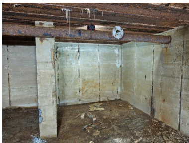
Vue de détail de la salle de garde : elle est partiellement divisée par un mur de refend. Au plafond, tuyauterie du système de ventilation Phot. Bernard Bègne IVR53_20253501387NUCA
