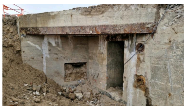
Vue de détail de l'élévation est : entrée sud flanquée par la caponnière (couverture photographique du 17 décembre 2025). L'ouverture de tir blindée de la caponnière est masquée par le remblai Phot. Guillaume Lécueillier IVR53_20263510063NUCA
