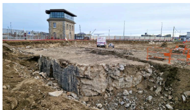
Vue générale depuis le sud-ouest (couverture photographique du 17 décembre 2025). La partie sud-ouest du bunker a été partiellement arasée dans les années 1970 Phot. Guillaume Lécueillier IVR53_20263510058NUCA
