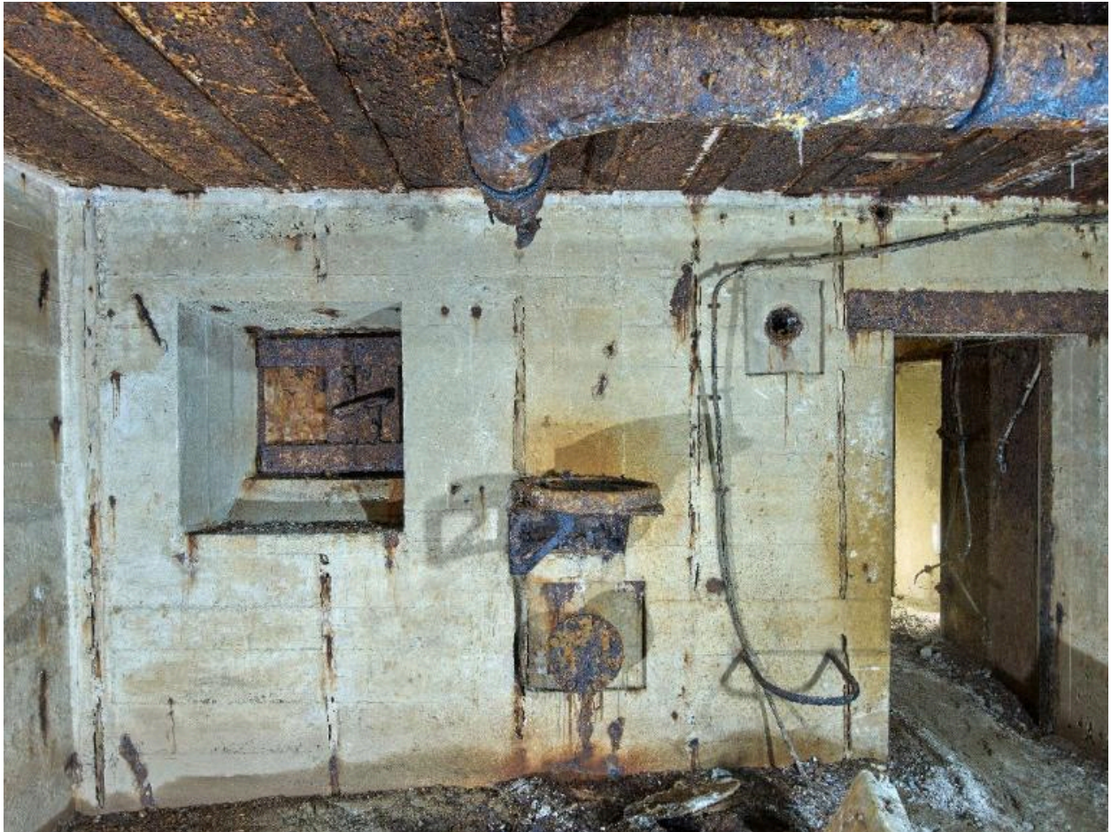
Vue de détail de la salle de garde : de gauche à droite, ouverture de tir blindée de l'entrée nord ; emplacement du système de ventilation avec arceau pour les filtres à charbon et tuyauterie au plafond ; à droite, porte étanche d'accès
