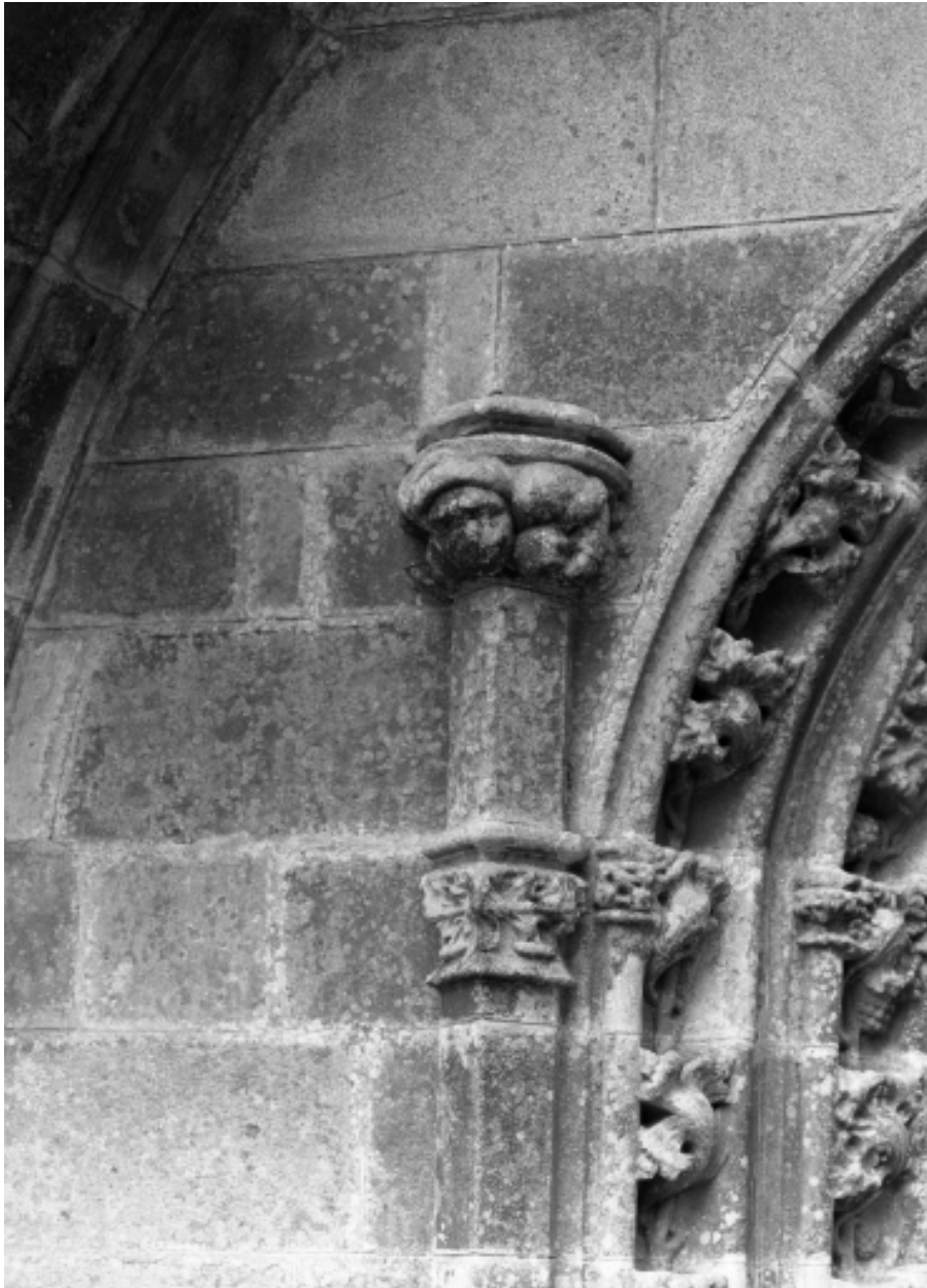
Châteauneuf-du-Faou, chapelle Notre-Dame-des-Portes : détail du pinacle nord du portail, état en 1966
