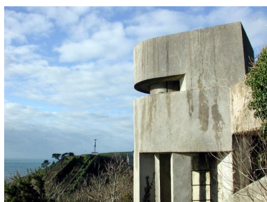
Vue du poste d'observation et de télémétrie n° 1 (état en 2003) Phot. Guillaume Lécueillier IVR53_20072905962NUCA
