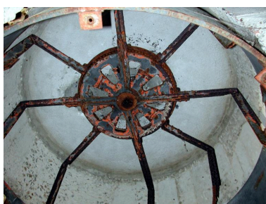
Vue intérieure du poste d'observation et de télémétrie n° 1 (état en 2003) Phot. Guillaume Lécueillier IVR53_20072905966NUCA
