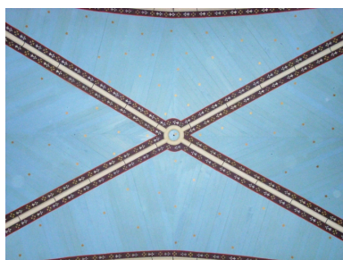
Landivisiau, chapelle Notre-Dame-de-Lourdes : lambris de couvrement dans la nef, détail Phot. Gwénaél Fauchille IVR53_20082906515NUCA
