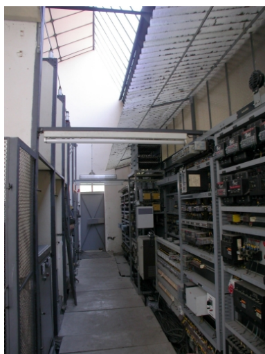
La "salle de relayage", vue intérieure. Phot. Marina Gasnier IVR53_20042203087NUCA
