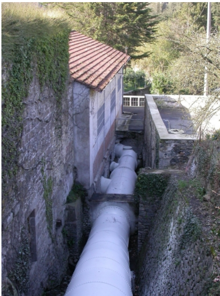
La salle des machines et la conduite forcée qui amène l'eau aux turbines.
