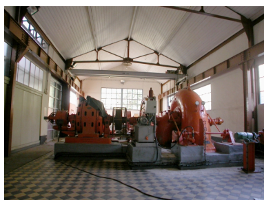
La salle des machines, vue intérieure. Phot. Marina Gasnier IVR53_20042203088NUCA
