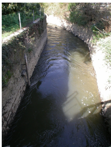
Canal de fuite : les eaux motrices après leur passage dans les turbines. Phot. Marina Gasnier
