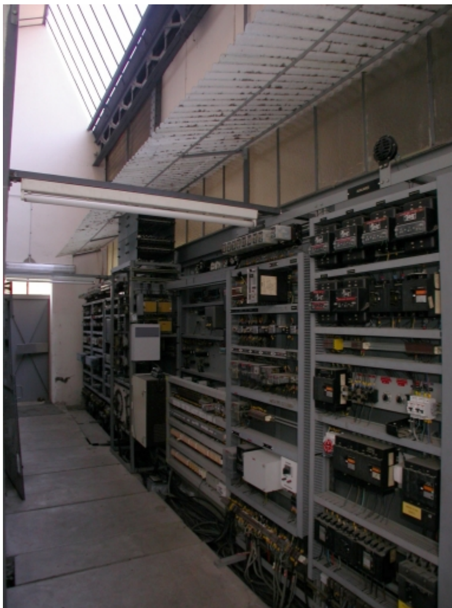
La "salle de relayage", vue intérieure.
