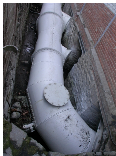
Détail de la conduite forcée avec répartiteur à trois branches dont un est hors d'usage. Phot. Marina Gasnier IVR53_20042203079NUCA
