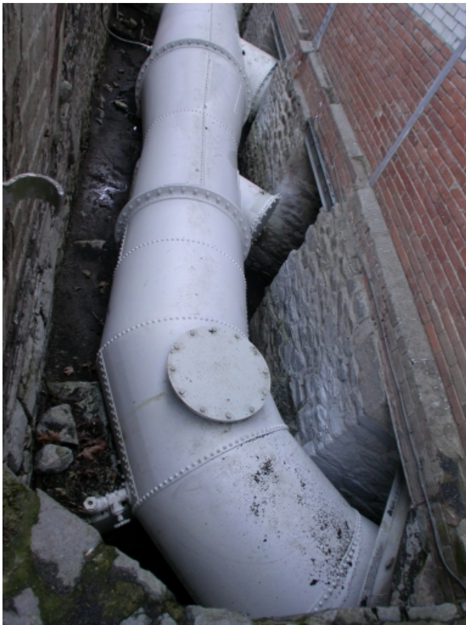
Détail de la conduite forcée avec répartiteur à trois branches dont un est hors d'usage.
