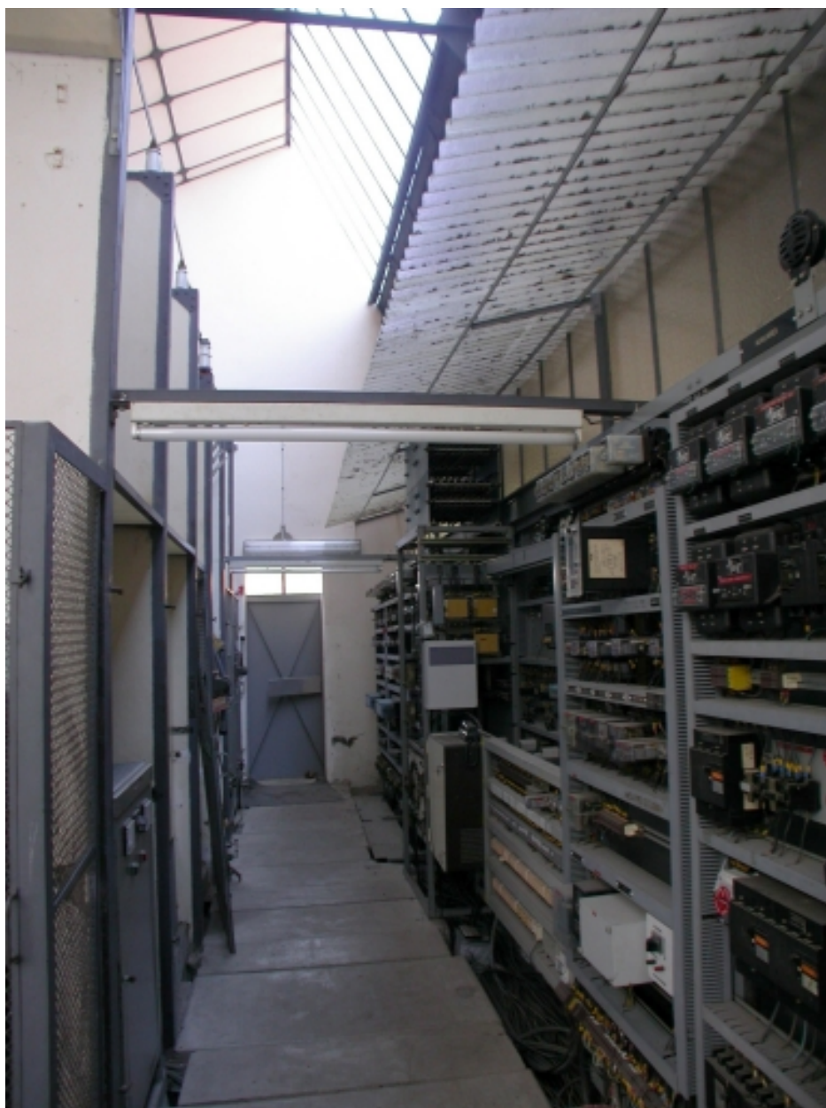
La "salle de relaying", vue intérieure.
