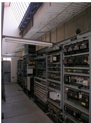
La "salle de relayage", vue intérieure. Phot. Marina Gasnier IVR53_20042203090NUCA
