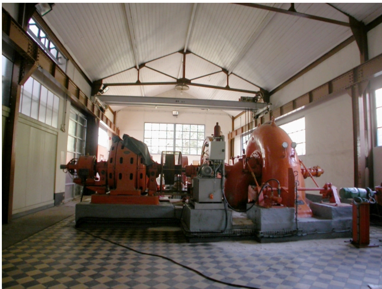
La salle des machines, vue intérieure.
