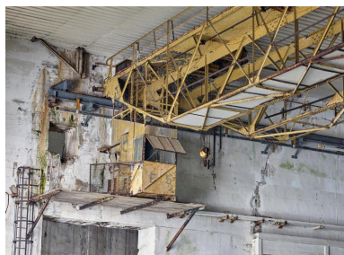
Vue du pont roulant de l'alvéole D (n° 19, 19a et 20). Sa capacité est de 5 tonnes. On peut lire l'inscription "lot 008" Phot. Bernard Bègne IVR53_20235600101NUCA
