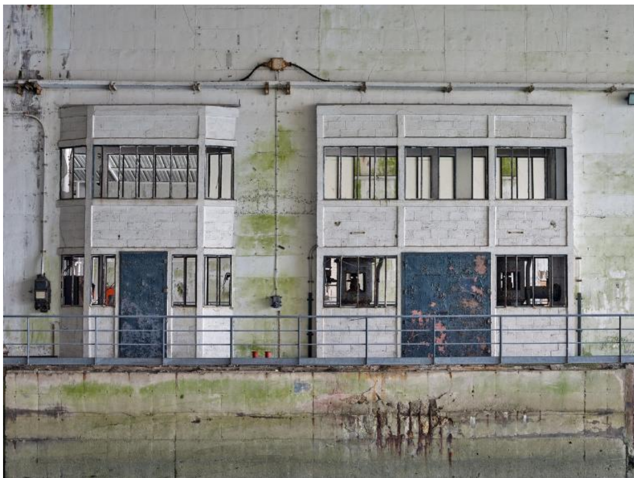
Vue générale de la salle des pompes de l'alvéole D (quai n° 19) aménagée dans l'épaisseur du mur de refend
