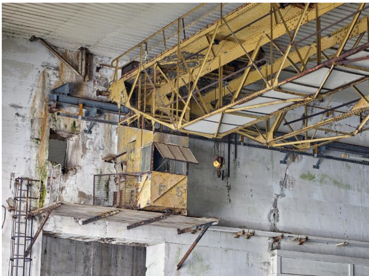
Vue du pont roulant de l'alvéole D (n° 19, 19a et 20). Sa capacité est de 5 tonnes. On peut lire l'inscription "lot 008"
