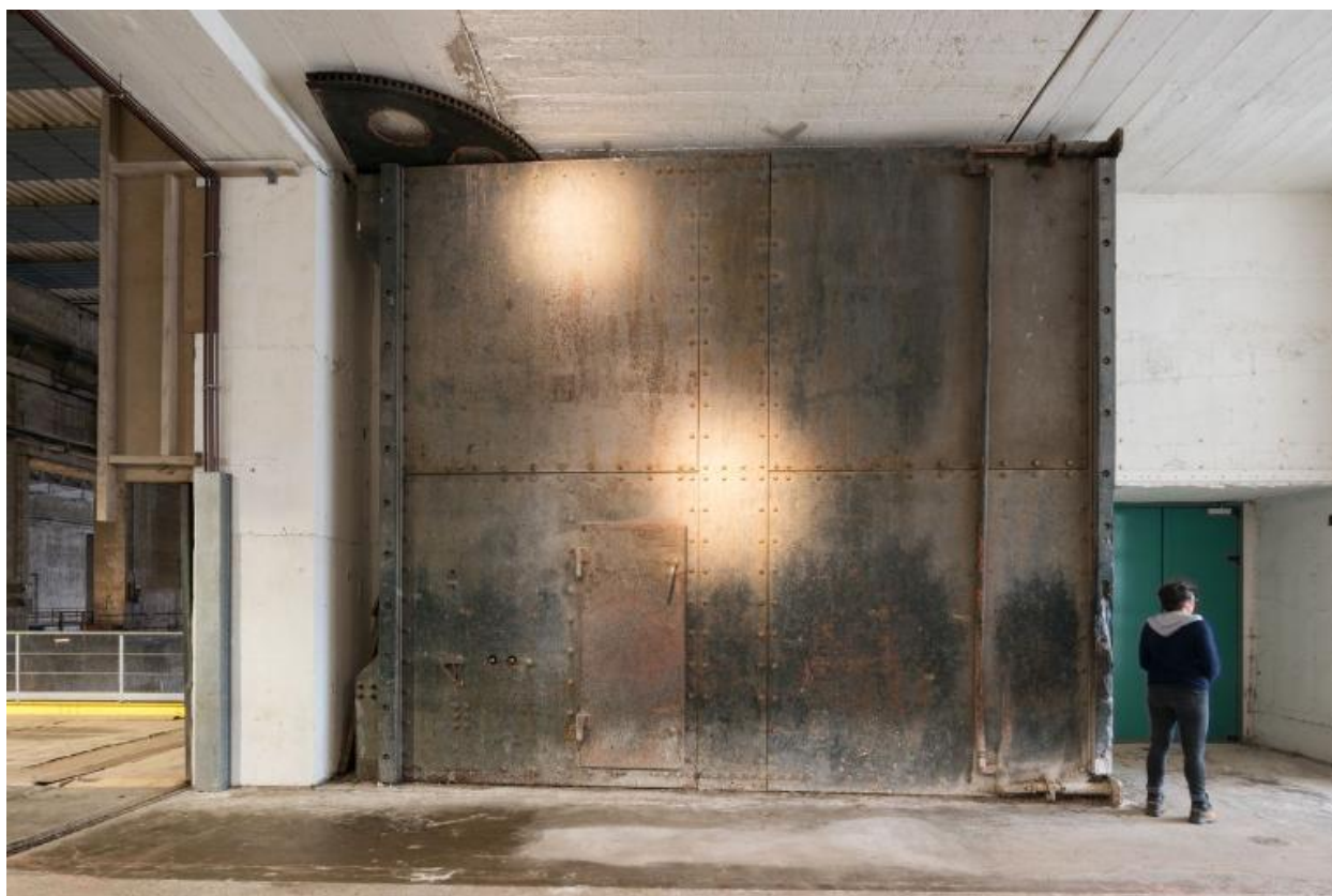
Vue de la porte blindée de l'entrée ouest
