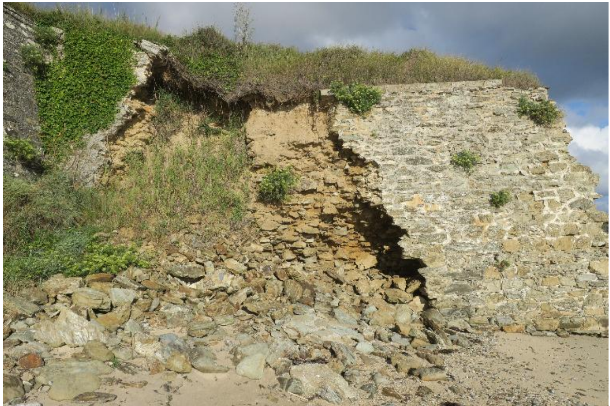
Locmaria, Grands Sables, dégâts sur l'escarpe.
