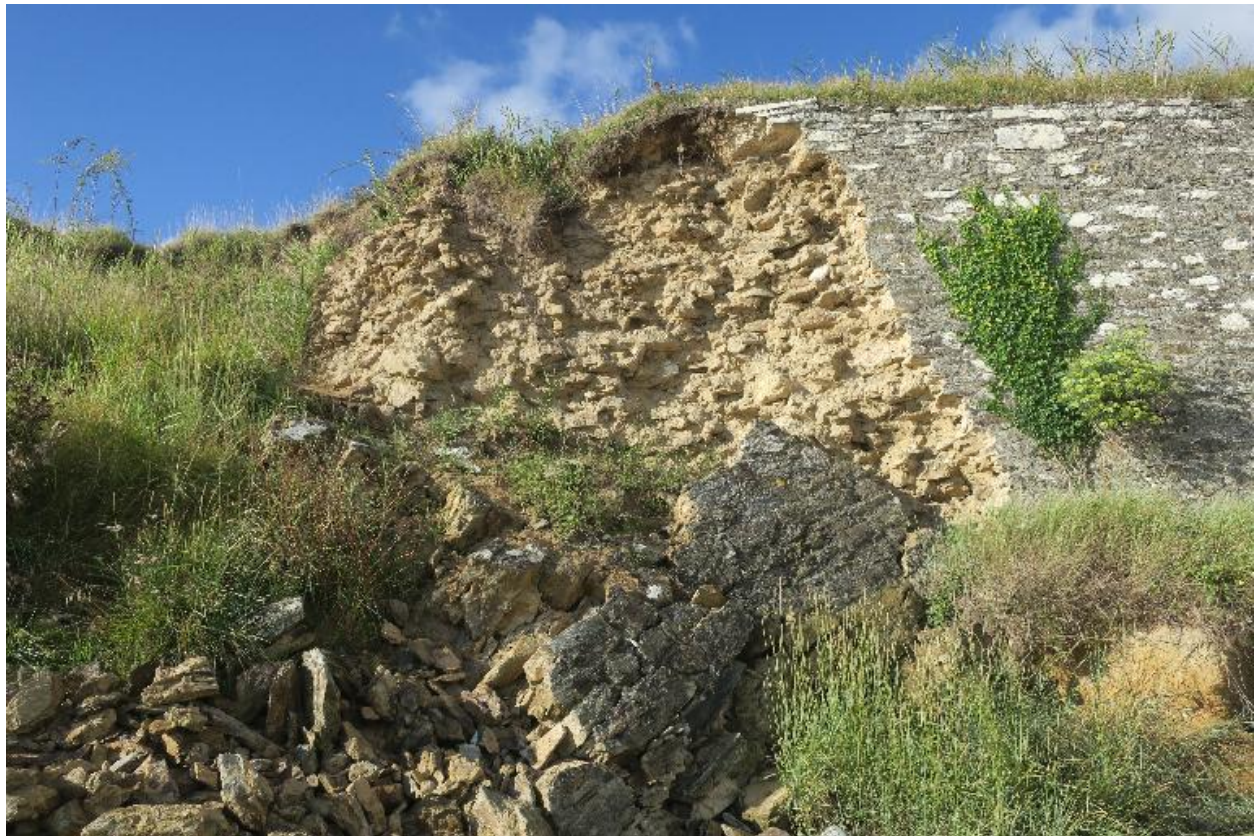
Locmaria, Grands Sables, dégâts sur l'escarpe.
