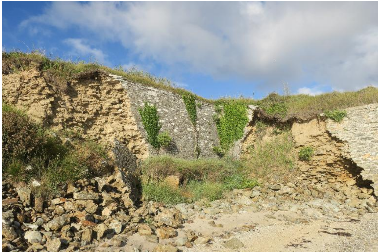
Locmaria, Grands Sables, dégâts sur l'escarpe.
