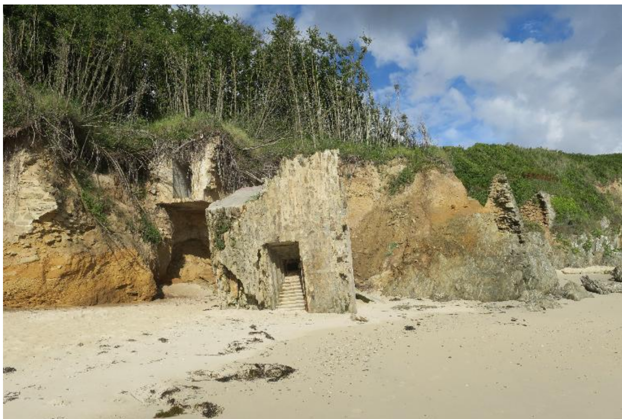
Locmaria, Grands Sables, extrémité ouest effondrée.
