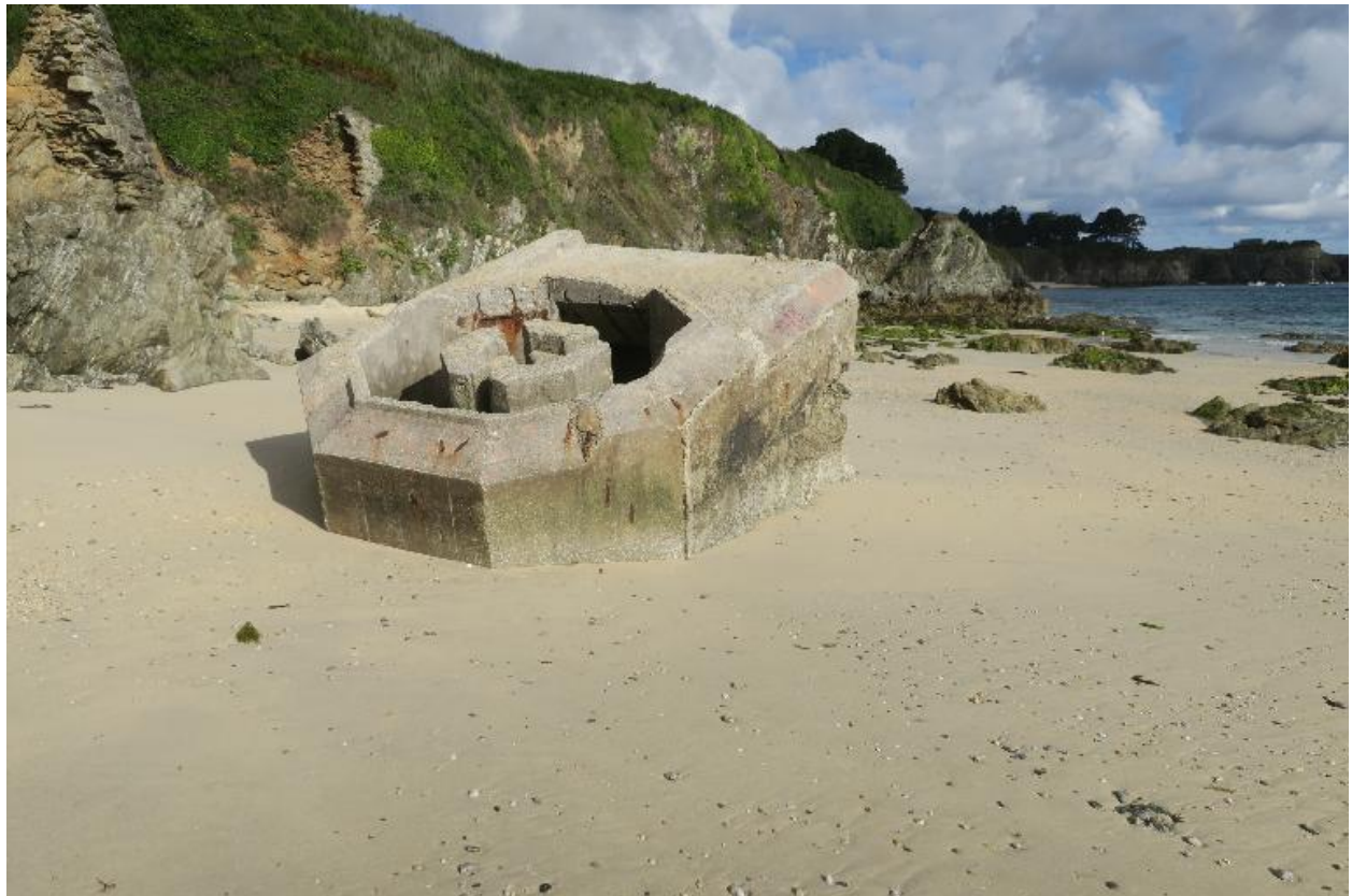
Locmaria, Grands Sables, extrémité ouest effondrée.
