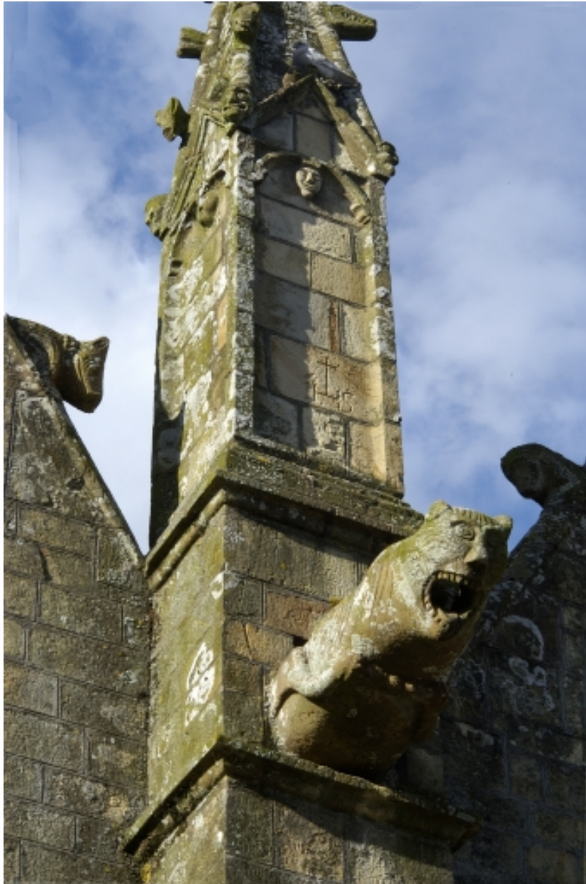
Façade sud, contrefort marqué du monogramme IHS : détail
