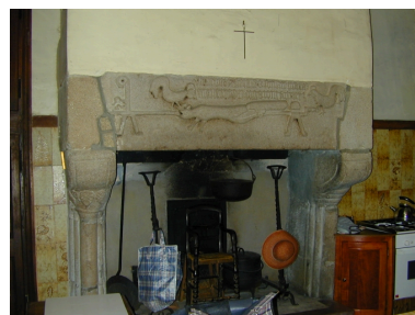
Logis, intérieur, cheminée de la cuisine : vue générale Phot. Xavier Gilbert IVR53_20023511344NUCA
