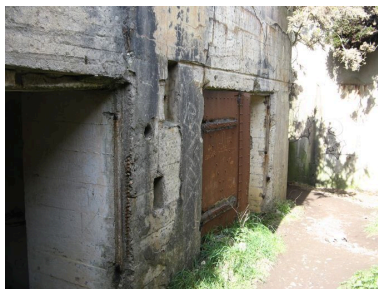
Locaux du poste de tir de la batterie du cap de la Chèvre Phot. Guillaume Marie IVR53_20082908325NUCA
