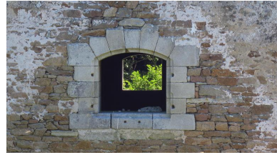
Fort central, Île-d'Houat. Magasin à poudre, détail de la fenêtre de la façade nord Phot. Lionel Duigou IVR53_20165606098NUCA
