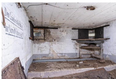
Vue intérieure : ouvertures de tir avec double volet blindé et support d'affût en bois pour mitrailleuse (état en 2026). A gauche : peinture murale de propagande. On peut transcrire : Dem Landser ist die Ruhe neig / Nur Verrückte haben#s eilig !! Phot. Charlotte Barraud IVR53_20262900201NUCA
