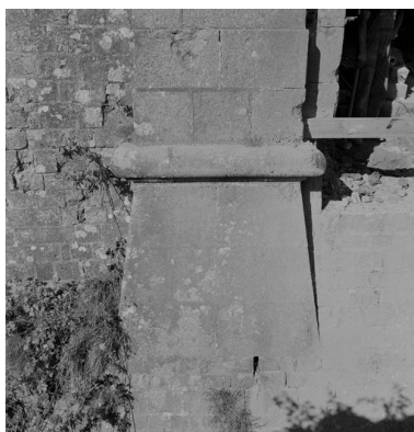
Vue du réduit de Quéléren en 1969 : détail du soubassement du pilastre de la porte d'entrée monumentale datée 1854 Phot. Guy Artur IVR53_19692900166X
