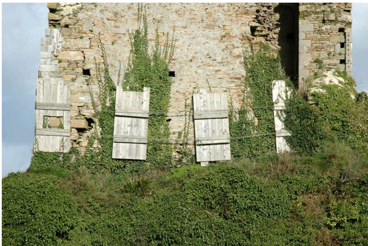
Vue du donjon partiellement envahi par la végétation (consolidation par étaieement mise en place en 2000)
