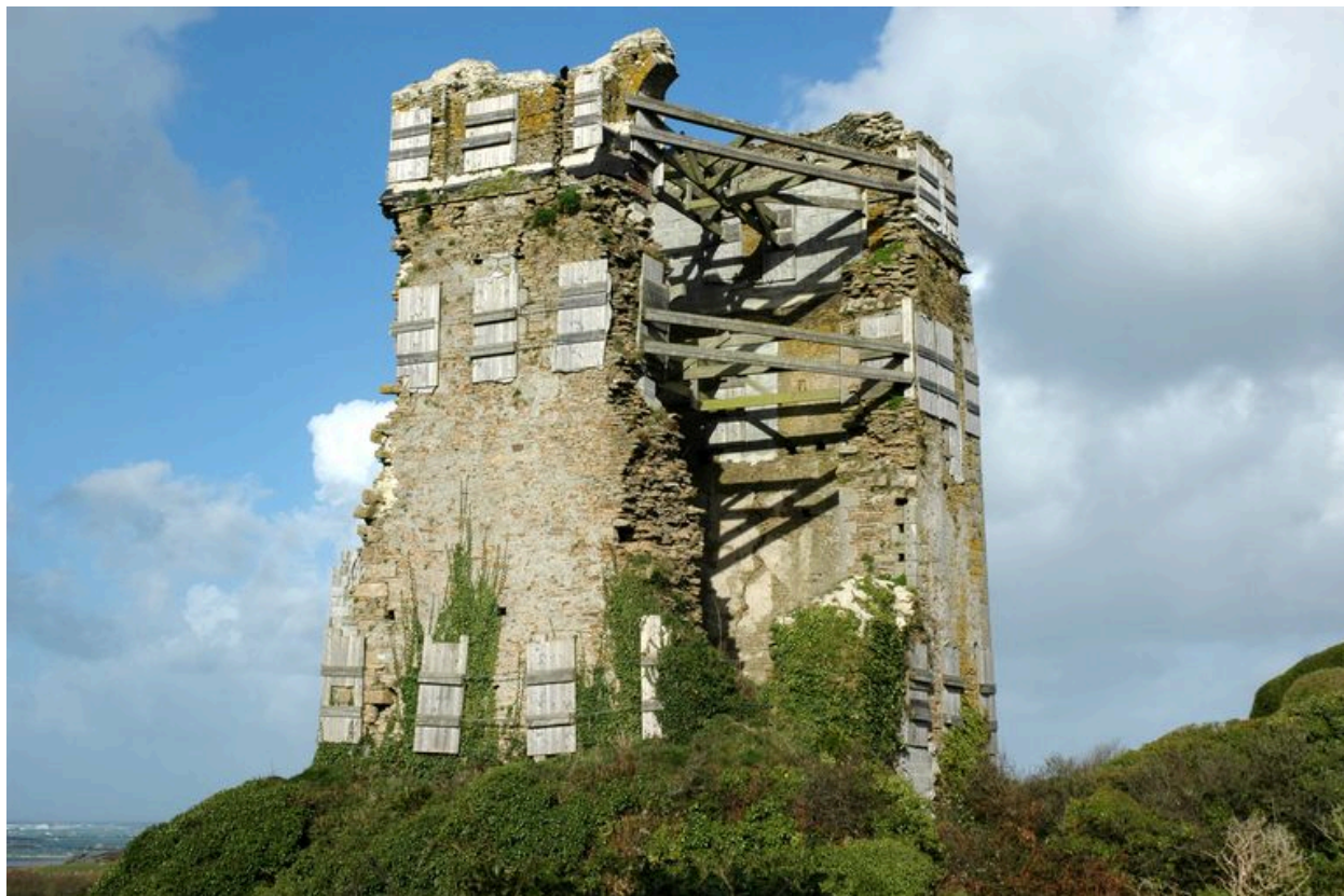
Vue générale du donjon (consolidation par étaieiment mise en place en 2000)
