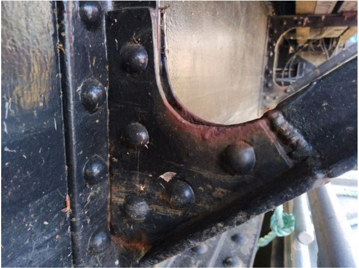
Le pont tournant du port du Légué : détail des rivets de la structure métallique
