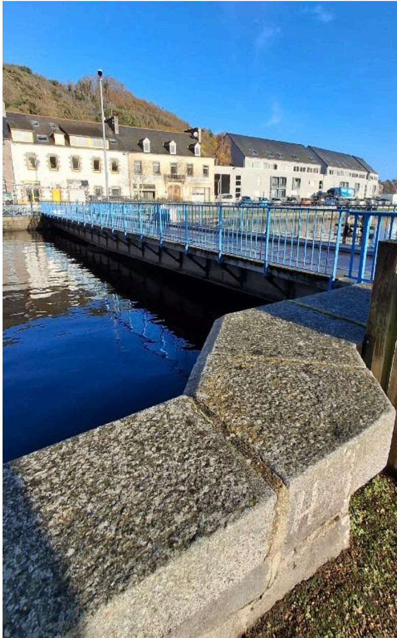
Le pont tournant dans son environnement portuaire et urbain et maçonnerie rive droite
