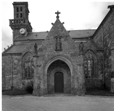
Quéménéven, église paroissiale Saint-Ouen : façade sud, le porche, état en 1972 Phot. François Dagorn IVR53_19722900751V
