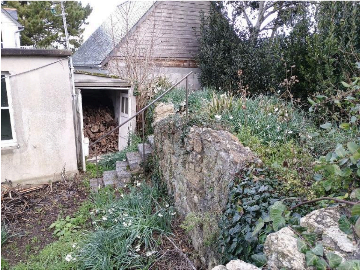
Vue des vestiges du mur de soutènement de la digue dans la parcelle section CA, n° 559 depuis la parcelle CA, n° 558
