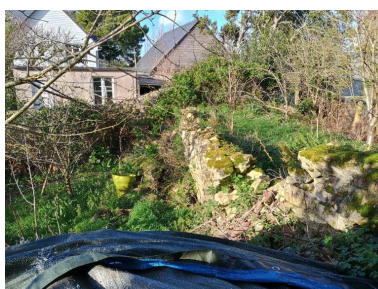
Vue des vestiges de la digue dans la parcelle section CA, n° 558 depuis la parcelle CA, n° 557 Phot. Alain Bargain IVR53_20263510290NUCA
