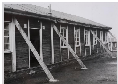
Collège technique en baraques. Salle de classe de dessin (d'après Le Télégramme, du 28 novembre 1952, qui publie cette photographie), nécessitant des étais pour tenir debout. Autr. Robert Grenier IVR53_20212900437NUCA
