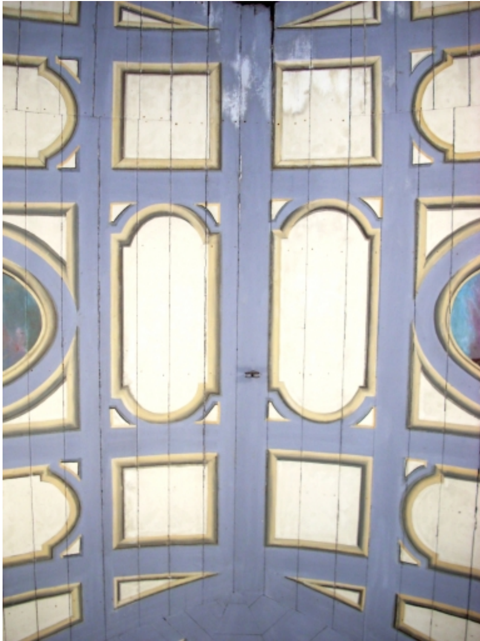
Morlaix, chapelle du cimetière Saint-Charles : lambris de couverture dans la nef, détail
