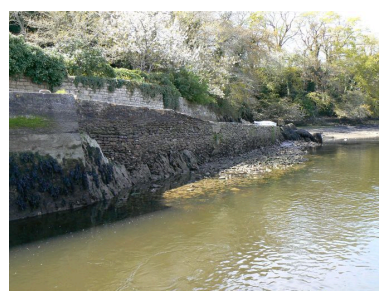
Chemin submersible après le quai Polignac Phot. Julien Amghar IVR53_20082908657NUCA
