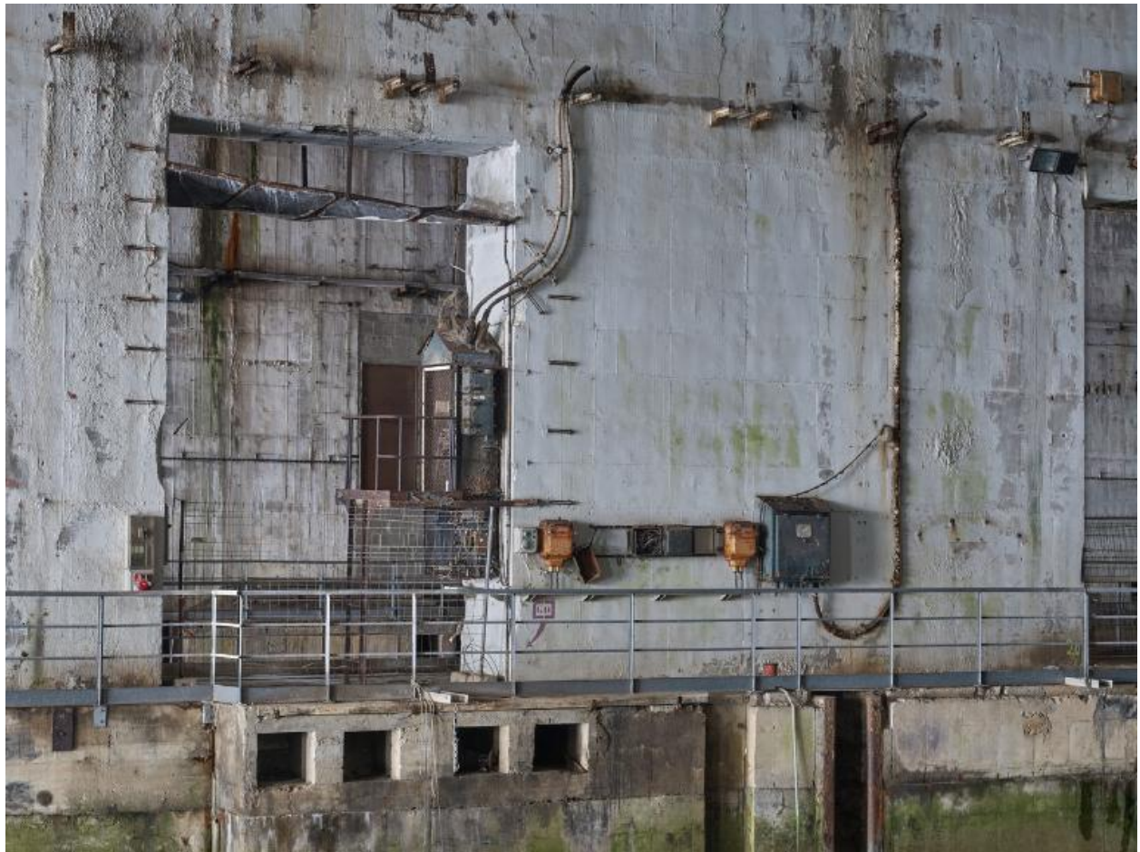
Vue du mur de refend situé entre les alvéoles C (quai n° 21) et D (quai n° 20) : sur les murs, les installations électriques
