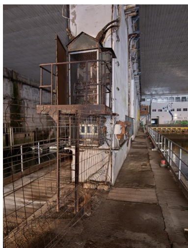
Vue du mur de refend situé entre les alvéoles C et D : armoire électrique Phot. Bernard Bègne IVR53_20235600078NUCA
