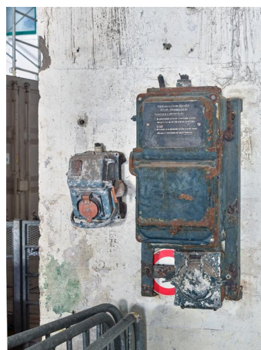
Vue de deux boîtiers électriques. A droite, un boîtier de prise de courant triphasée. Sur le
