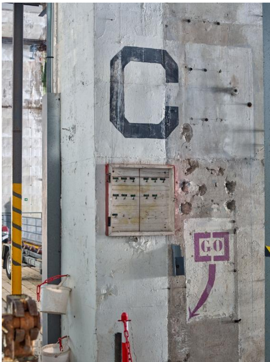
Vue du marquage alphabétique de l'alvéole. Sur le mur, tableau à clés avec étiquettes et inscription GO à la peinture rouge pour gasoil et la flèche indiquant l'endroit où se brancher
