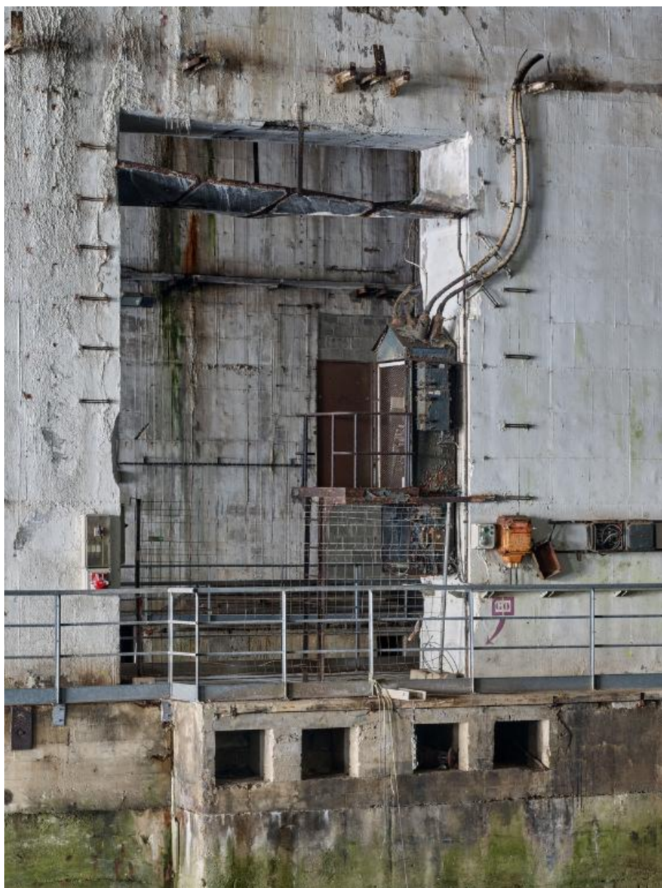
Vue du mur de refend situé entre les alvéoles C (quai n° 21) et D (quai n° 20) : sur les murs, les installations électriques
