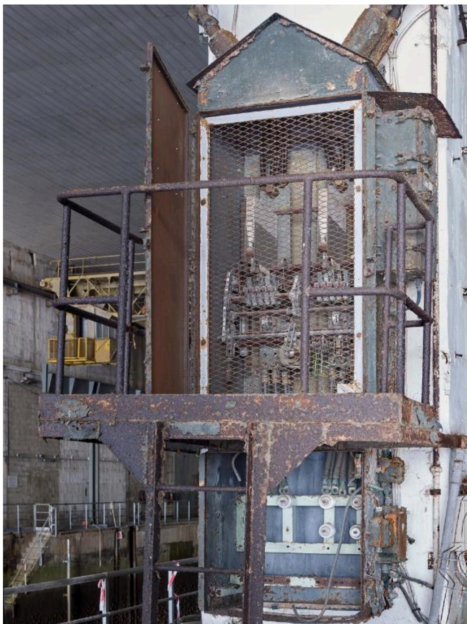
Vue du mur de refend situé entre les alvéoles C et D : armoire électrique
