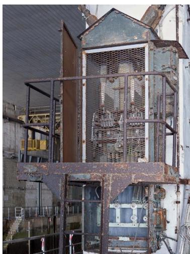
Vue du mur de refend situé entre les alvéoles C et D : armoire électrique Phot. Bernard Bègne IVR53_20235600080NUCA
