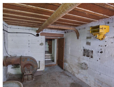
Vue de la salle de ventilation depuis l'entrée côté alvéole G : équipements en place (filtre dépoussiéreur peint de couleur jaune, gaines de ventilation, porte étanche et ventilateur industriel...). Sur les murs, les traces du matériel disparu : ici, un ventilateur Phot. Bernard Bègne IVR53_20215600469NUCA
