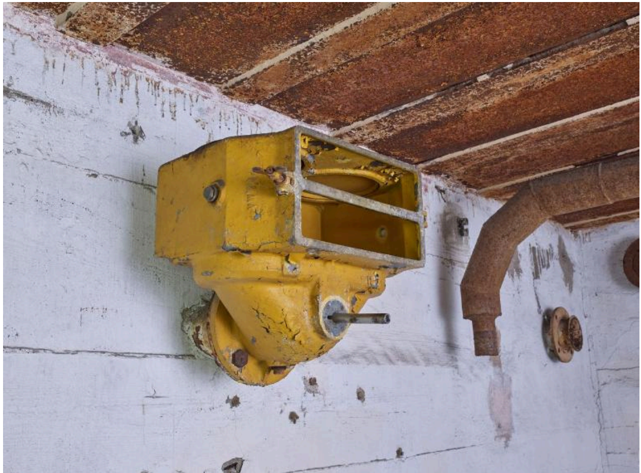
Vue du filtre dépoussiéreur de la salle de ventilation (la plaque constructeur a disparu)
