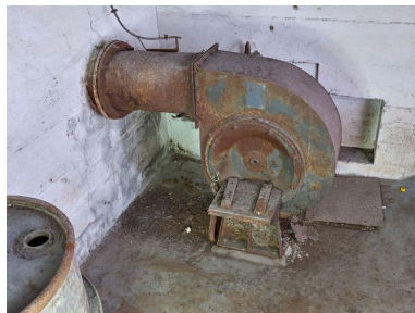
Vue du ventilateur industriel pour l'extraction des fumées de tir (la plaque constructeur a disparu) Phot. Bernard Bègne IVR53_20215600473NUCA
