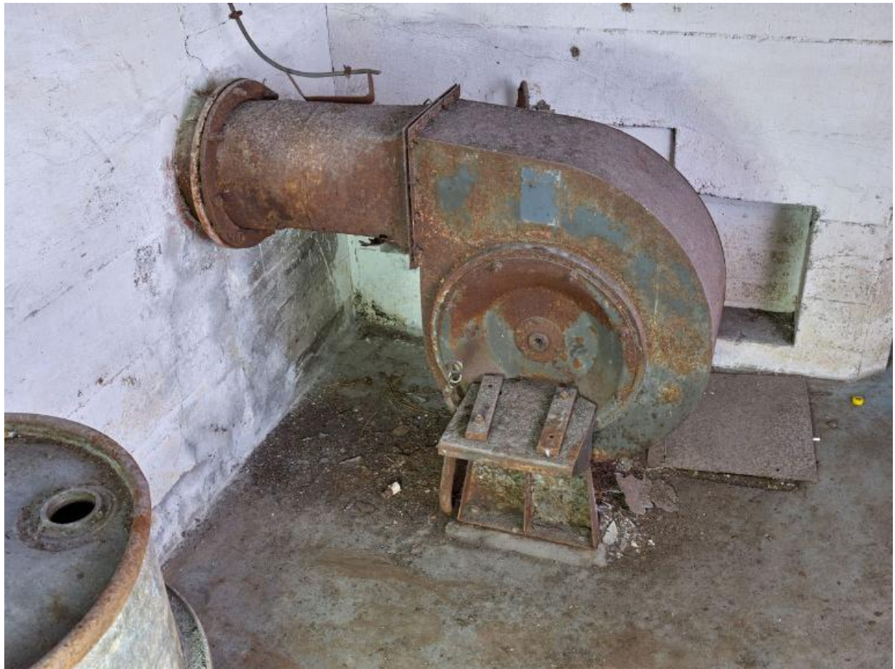
Vue du ventilateur industriel pour l'extraction des fumées de tir (la plaque constructeur a disparu)
