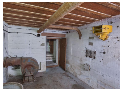
Vue de la salle de ventilation depuis l'entrée côté alvéole G : équipements en place (filtre dépoussiéreur peint de couleur jaune, gaines de ventilation, porte étanche et ventilateur industriel...). Sur les murs, les traces du matériel disparu : ici, un ventilateur Phot. Bernard Bègne IVR53_20215600469NUCA
