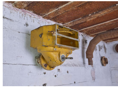
Vue du filtre dépoussiéreur de la salle de ventilation (la plaque constructeur a disparu) Phot. Bernard Bègne IVR53_20215600472NUCA
