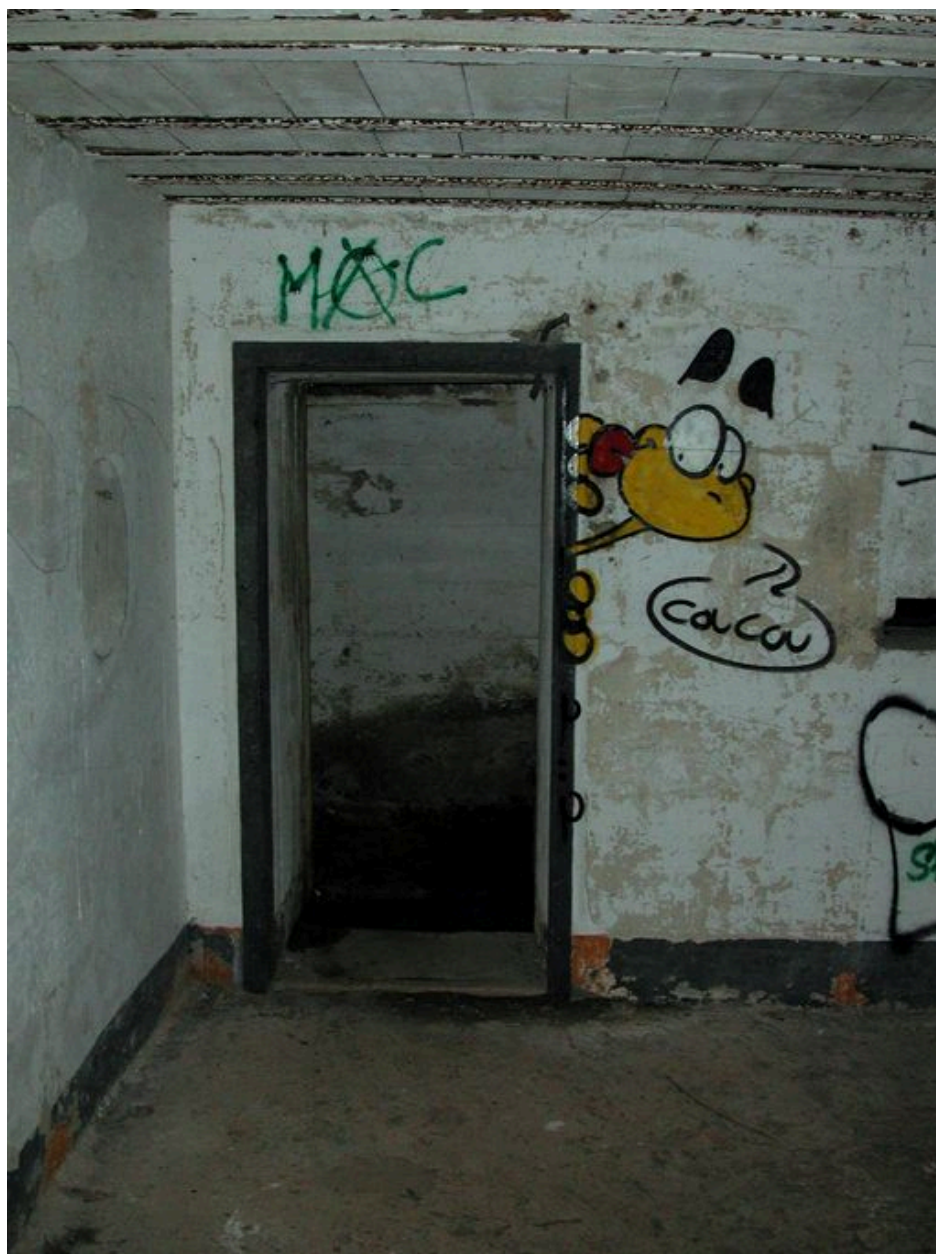
Vue intérieure de l'un des postes d'observation et de télémétrie : bâtiment n° 1 (état en 2007)
