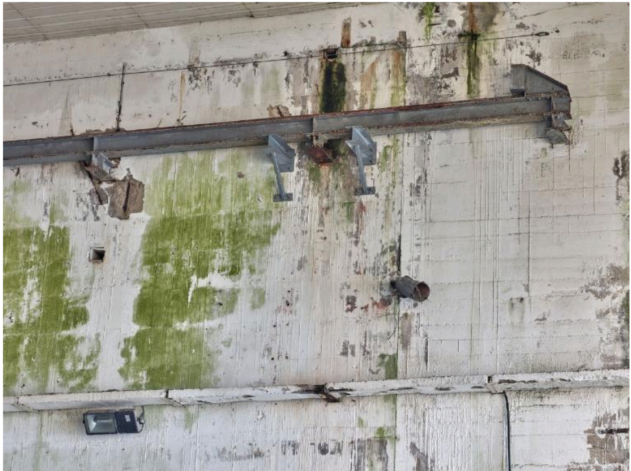
Vue de l'alcôve E (n° 17 et 18) : côté quai est n° 17, chemin de roulement du pont-roulant et projecteur dirigé vers les portes d'écluse
