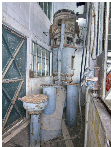
Vue de la salle des pompes située entre les alvéoles D (n° 19, 19a et 20) et E (n° 17 et 18) : l'un des tuyaux a été déposé Phot. Bernard Bègne IVR53_20235600089NUCA
