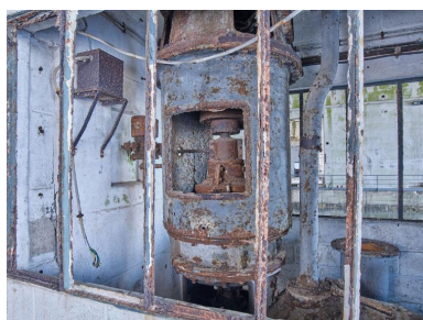
Vue de la salle des pompes située entre les alvéoles D (n° 19, 19a et 20) et E (n° 17 et 18) Phot. Bernard Bègne IVR53_20235600086NUCA
