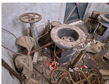
Vue de la salle des pompes située entre les alvéoles D (n° 19, 19a et 20) et E (n° 17 et 18) : les pompes ont été démontées Phot. Bernard Bègne IVR53_20235600074NUCA
