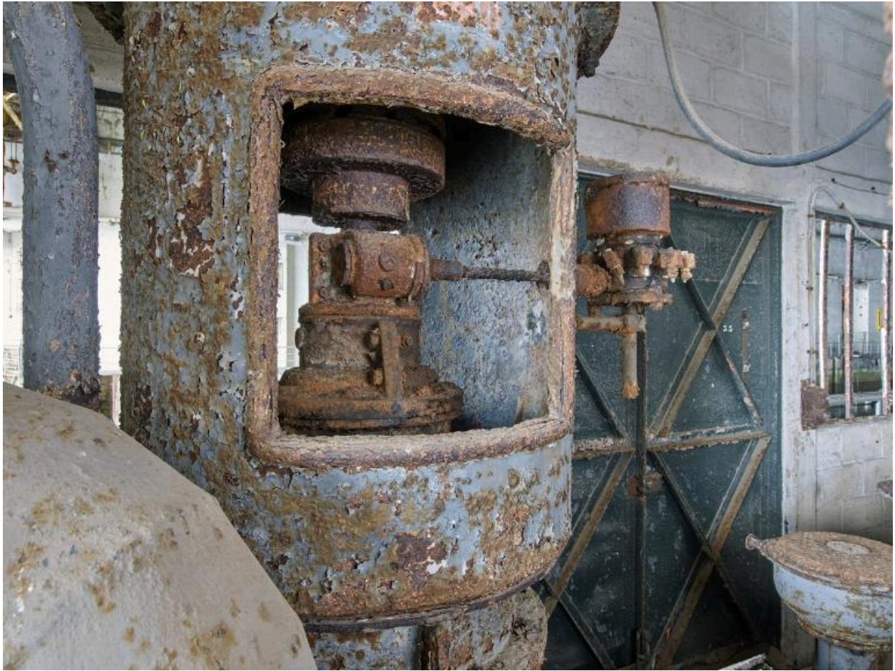
Vue de la salle des pompes située entre les alvéoles D (n° 19, 19a et 20) et E (n° 17 et 18) : détail du système
