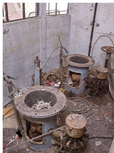
Vue de la salle des pompes située entre les alvéoles D (n° 19, 19a et 20) et E (n° 17 et 18) : les pompes ont été démontées Phot. Bernard Bègne IVR53_20235600075NUCA
