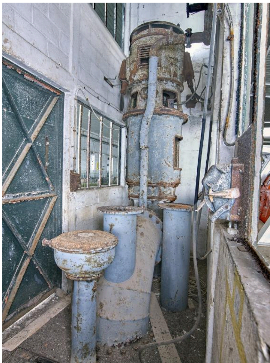
Vue de la salle des pompes située entre les alvéoles D (n° 19, 19a et 20) et E (n° 17 et 18) : l'un des tuyaux a été déposé
