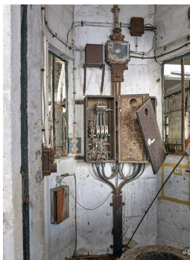
Vue de la salle des pompes située entre les alvéoles D (n° 19, 19a et 20) et E (n° 17 et 18) : sur les murs, faisceaux et tableaux électriques
