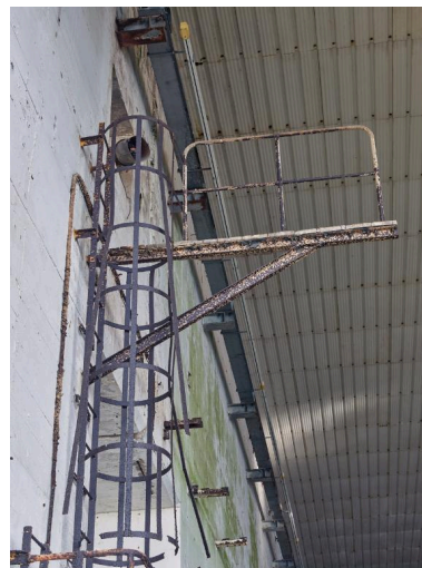
Vue de l'entrée de l'alvéole E (n° 17 et 18) : quai ouest n° 18, plate-forme avec accès par une échelle, projecteur (une paire) dirigé vers les portes d'écluse Phot. Bernard Bègne IVR53_20235600094NUCA
