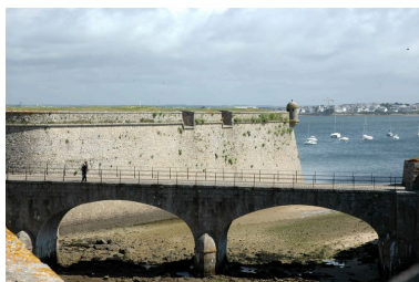
Vue de la citadelle de Port-Louis : grand pont en granite permettant de franchir le canal. En arrière-plan : le bastion Dumourier et son échauguette Phot. Guillaume Lécueillier IVR53_20065605296NUCA
