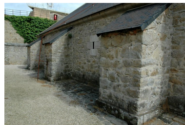
Vue de la citadelle de Port-Louis : contreforts du magasin à poudre Phot. Guillaume Lécueillier IVR53_20065605259NUCA
