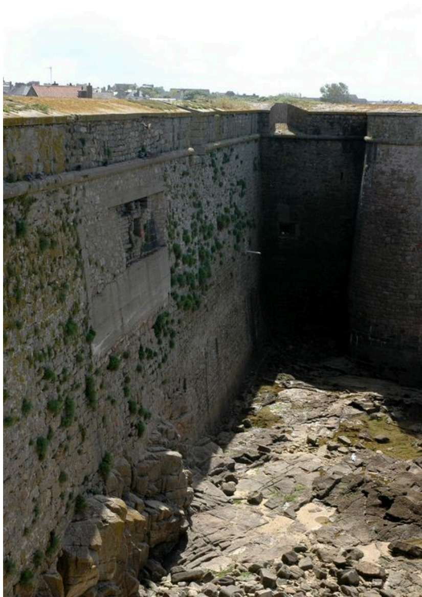
Vue de la citadelle de Port-Louis : courtine et orillon du bastion de Groix. A signaler qu'une casemate allemande a été aménagée dans l'épaisseur du rempart
