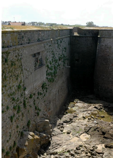
Vue de la citadelle de Port-Louis : courtine et orillon du bastion de Groix. A signaler qu'une casemate allemande a été aménagée dans l'épaisseur du rempart Phot. Guillaume Lécueillier IVR53_20065605280NUCA
