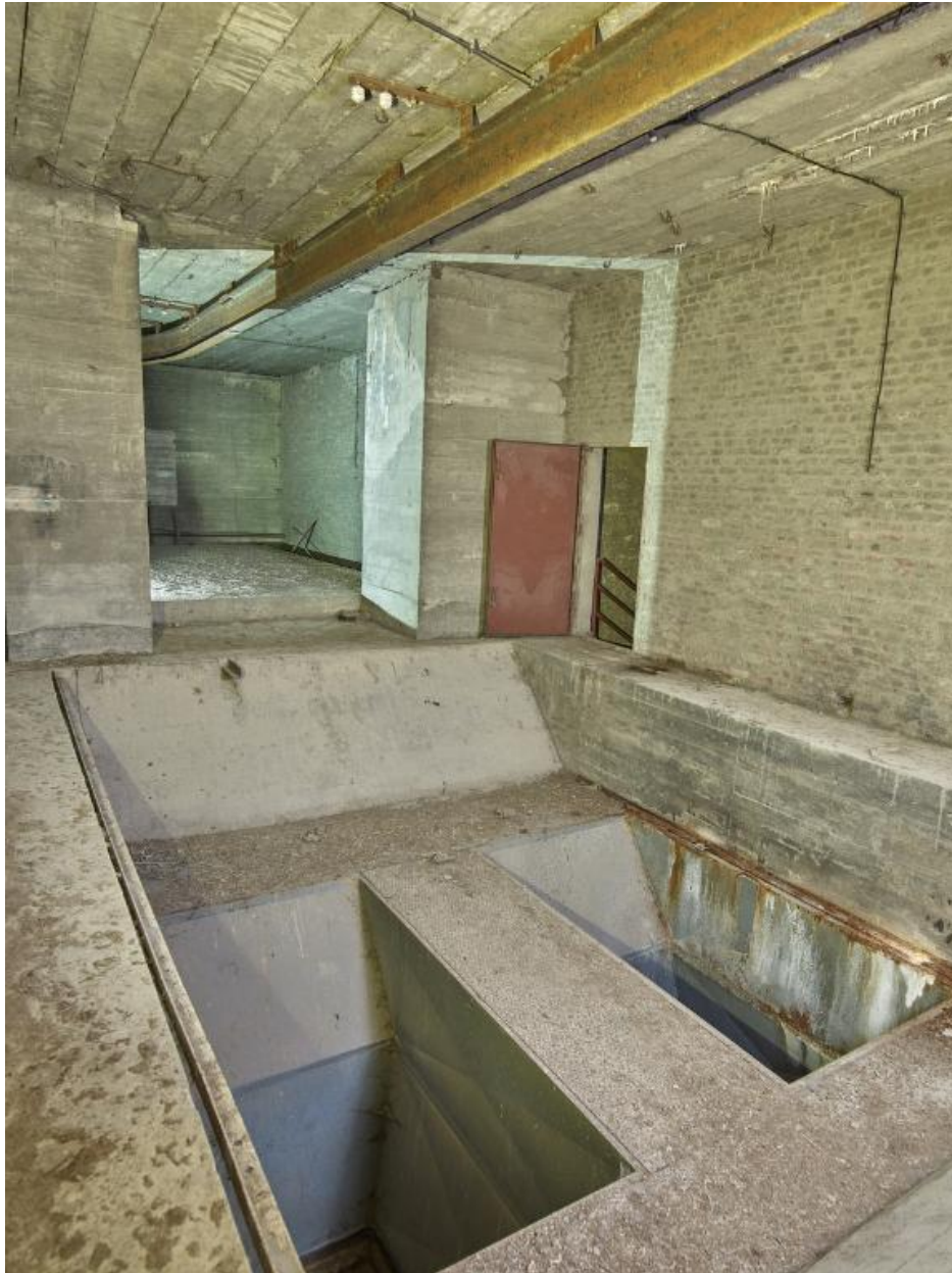
Vue du deuxième étage de l'extension sud : couloir d'accès aux trémies à charbon, monorail avec son système d'alimentation électrique triphasée. Au premier plan, l'une des trois trémies
