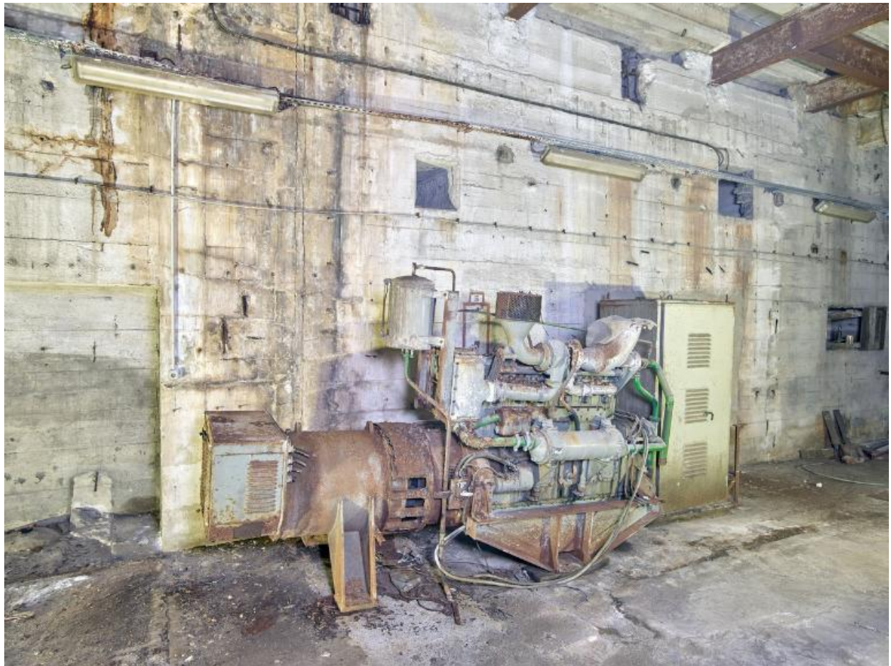
Vue de la salle du condenseur (fonction en 1945) puis atelier (fonction en 1966) dans l'extension sud : moteur sur son support et armoire électrique. Les échangeurs de chaleur sont de marque PICKER
