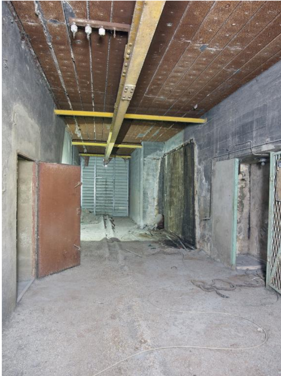
Vue du deuxième étage de l'extension sud : couloir d'accès aux trémies à charbon. Au plafond, monorail avec son système d'alimentation électrique triphasée. Au fond, l'accès vers l'extérieur (masqué par l'excroissance du slipway). A gauche, douche automatique (1966)
