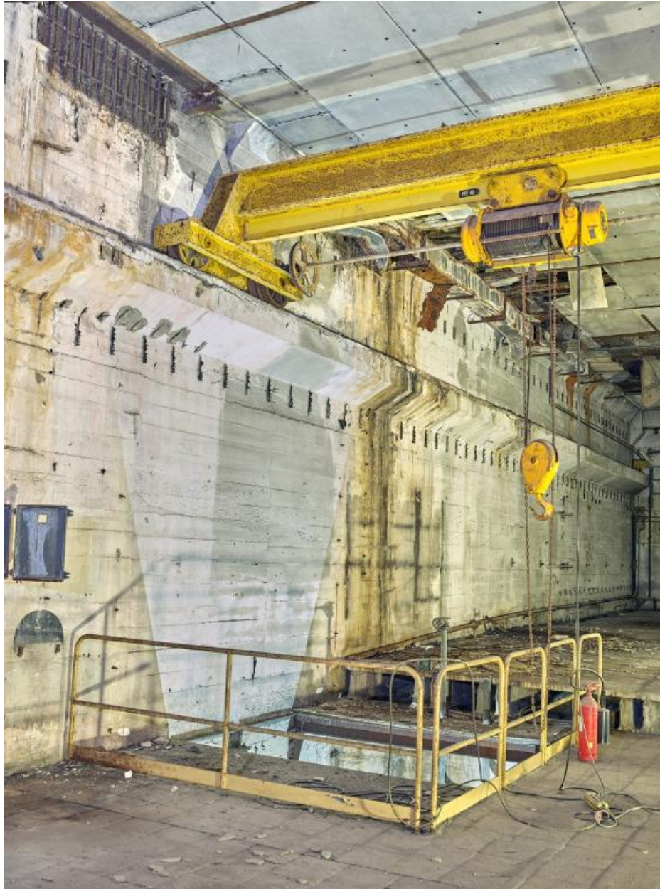
Vue de la salle du groupe turbo-dynamo (fonction en 1945), puis local des bouilleurs situé au premier étage de l'extension sud : puits monte-charge et pont roulant de la période allemande modernisé (PB2-80)
