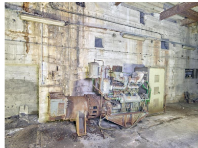
Vue de la salle du condenseur (fonction en 1945) puis atelier (fonction en 1966) dans l'extension sud : moteur sur son support et armoire électrique. Les échangeurs de chaleur sont de marque PICKER Phot. Bernard Bègne IVR53_20235600166NUCA
