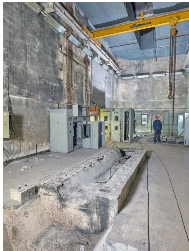
Vue générale de la chaudière est (fonction en 1945) située au rez-de-chaussée. Le pont roulant - de la période française - d'une capacité de 10 tonnes est de marque FENWICK (PB2-78). Au premier plan, l'emplacement du moteur Duvant. Sur les murs, des lampes fluorescentes Phot. Bernard Bègne IVR53_20235600169NUCA
