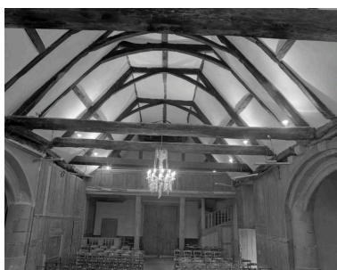
Vue intérieure, charpente, vue vers le bas de la nef, état vers 1980 Phot. Norbert Lambart IVR53_20133501302X
