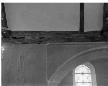
Vue intérieure, sablières et lambris de la nef, état vers 1980 Phot. Norbert Lambart IVR53_20133501308X
