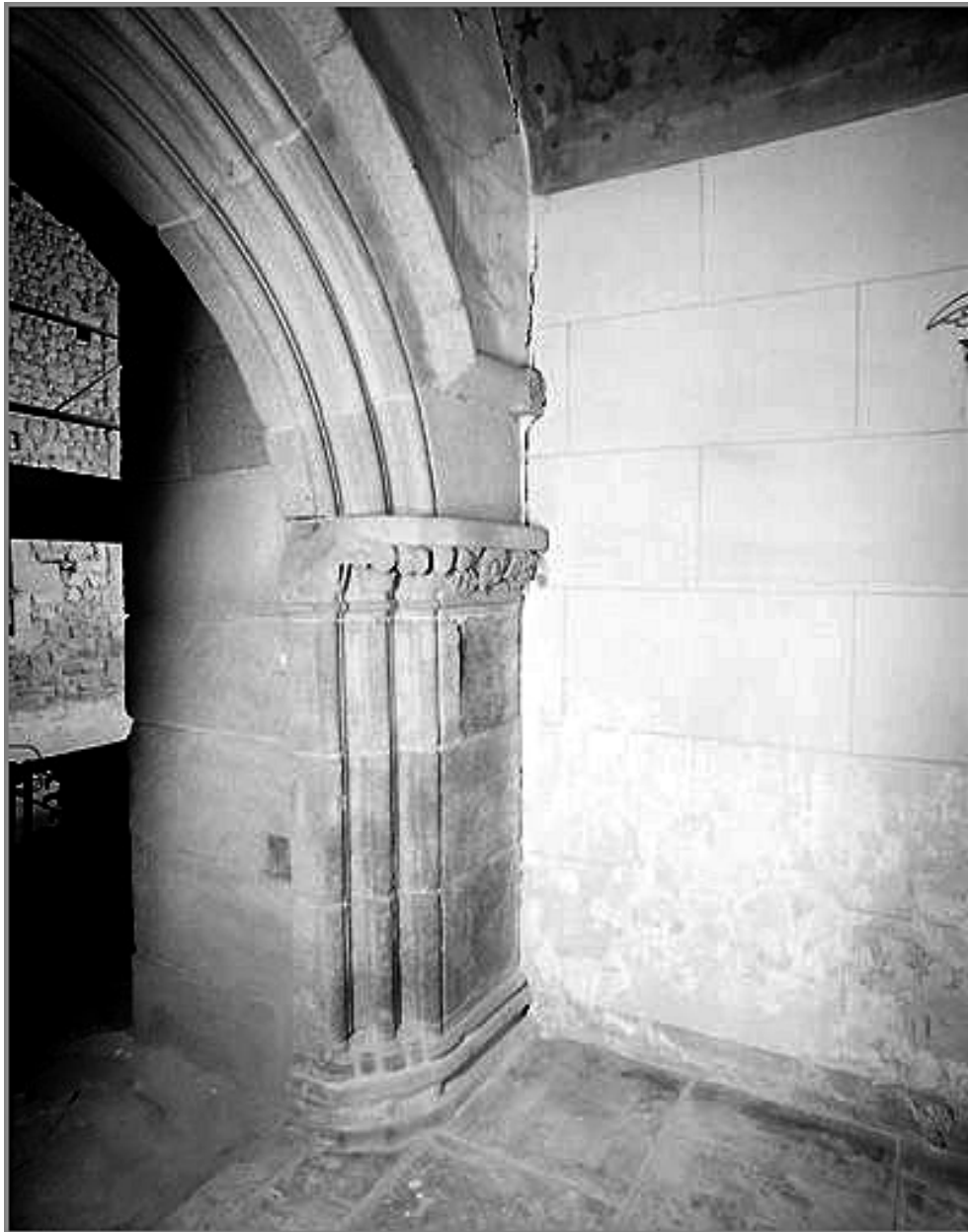
Intérieur, chapelle sud : détail d'une colonne avant restauration
