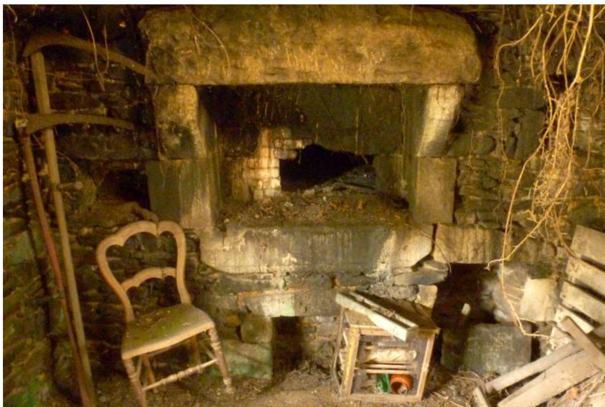
Fournil isolé au sud de la cour, détail de la cheminée et gueule du four. (2021)
